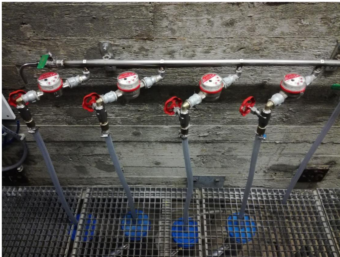
KUVA 8. Jakotukki, jolla syötetään hiekkasuodatettua vettä aktiivihiihpilotin neljälle suodatusputkelle ja säädetään veden virtaama (Heikkinen 2018-10-10)
