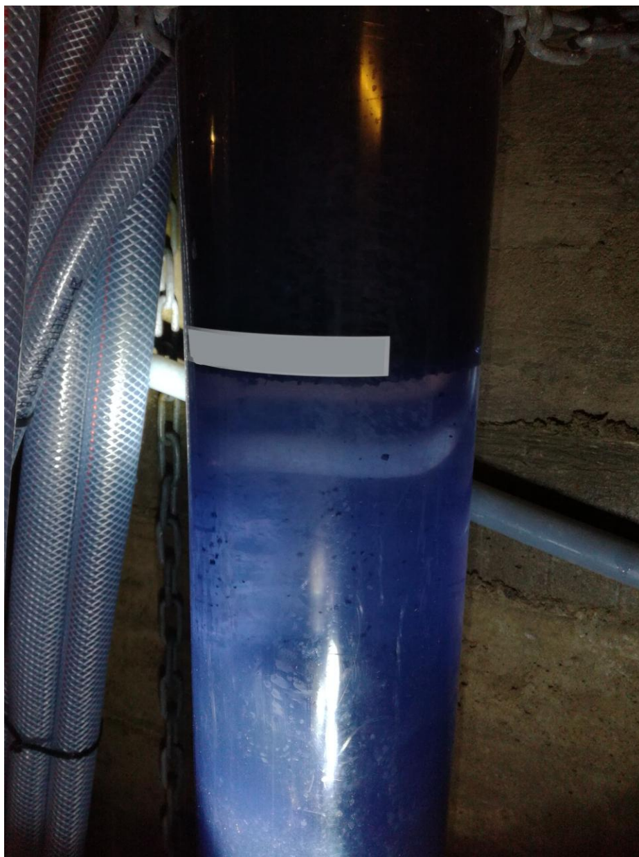
KUVA 21. Ensimmäisen vastavirtahuuhtelun aikana hiilipatja nousi kokonaisuudessa kohti kolonnin huuhteluputkea, eikä hiilien leijuntaa tapahtunut (Heikkinen 2018-10-30)
