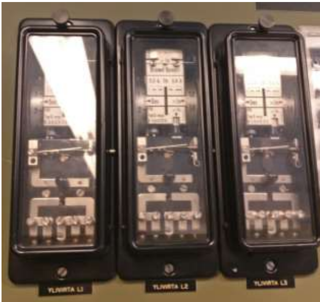
KUVA 7. Yksivaiheiset sähkömekaaniset ylivirtareleet.
