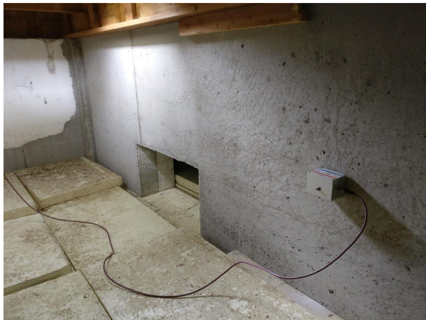
Kuva 2. Tärinämittarin anturi asennettuna omakotitalon sokkeliin (Partanen 2018).
