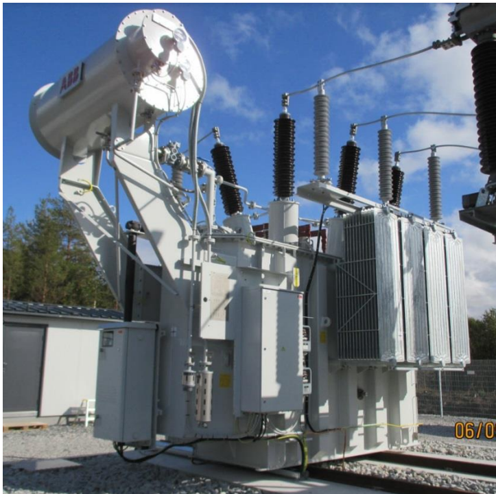
Kuva 2. Karungin sähköaseman 10 MVA:n päämuuntaja
