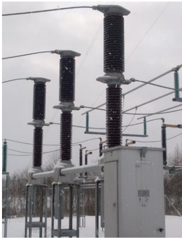
Kuva 8. ASEA LTB 110 kV SF 6 -katkaisija
