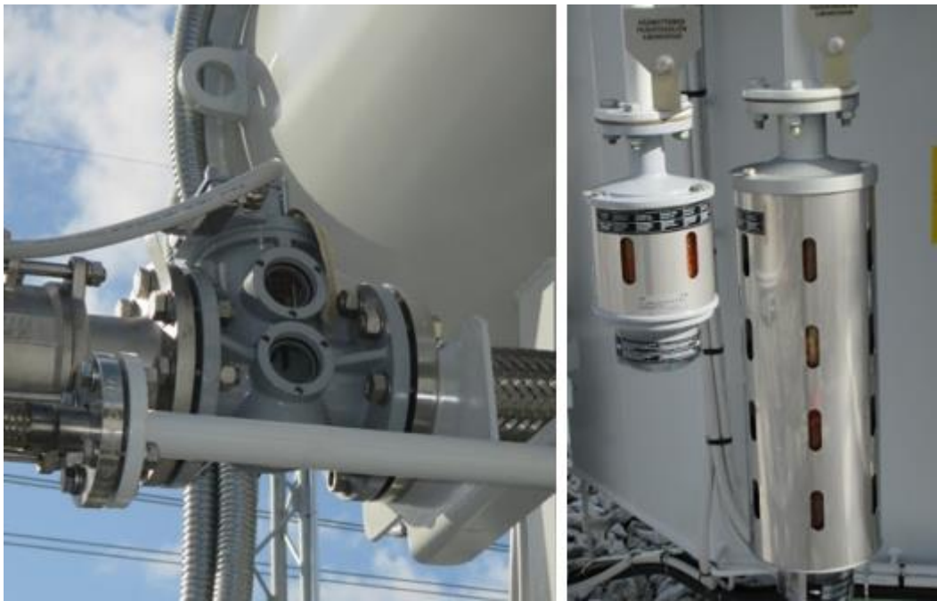
Kuva 7. Kaasurele ja ilmankuivaimet
