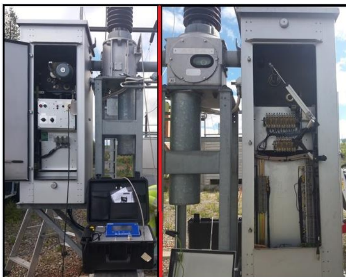
Kuva 9. SF 6 -katkaisijan ohjauslaitteisto
