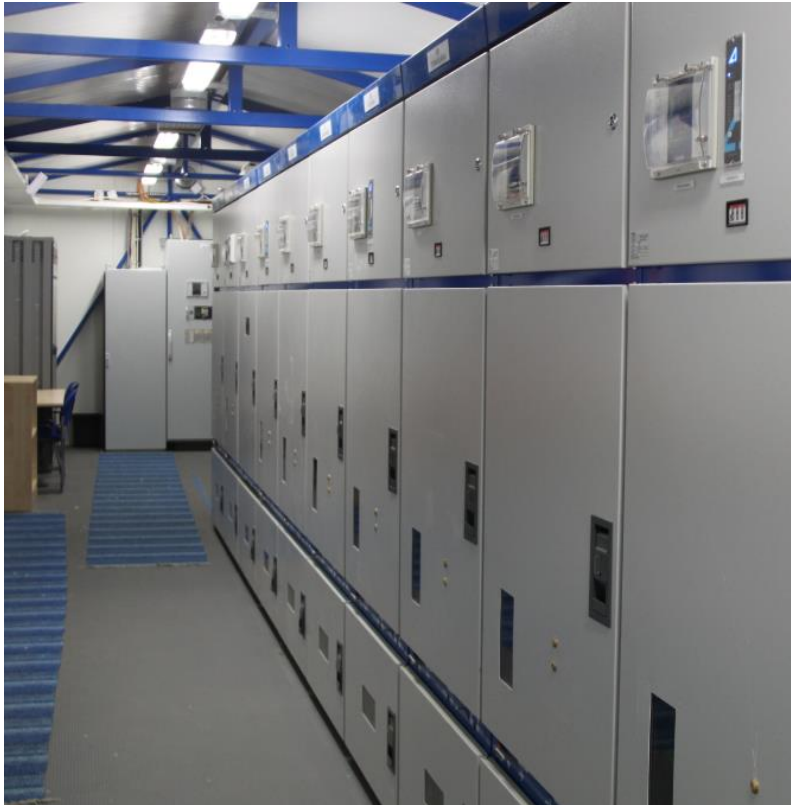
Kuva 16. Ylitornion sähköaseman keskijännitekojeisto VEKE 24
