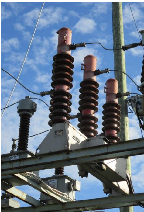
Kuva 10. Strömbergin 45 kV:n vähäöljykatkaisija
