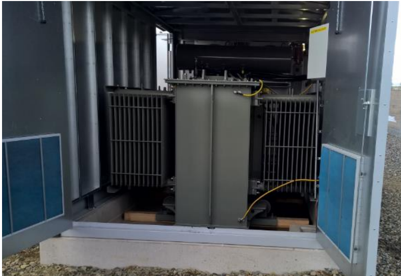
Kuva 23. 20 kV:n öljyeristeinen kiinteä reaktori Karungin sähköasemalla
