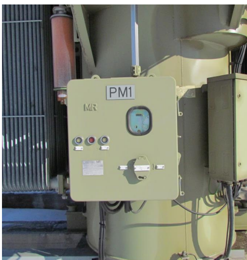
Kuva 5. Kuusimaan päämuuntajan käämikytkimen ohjainkotelo
