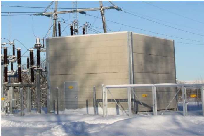
Kuva 4. Ylitornion sähköaseman muuntajabunkkeri
