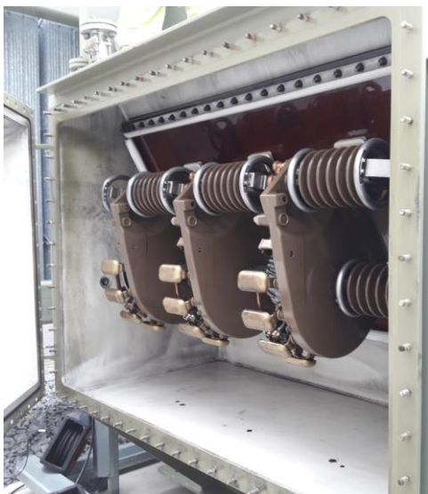
Kuva 6. Ylitornion sähköaseman PM1 käämikytkin
