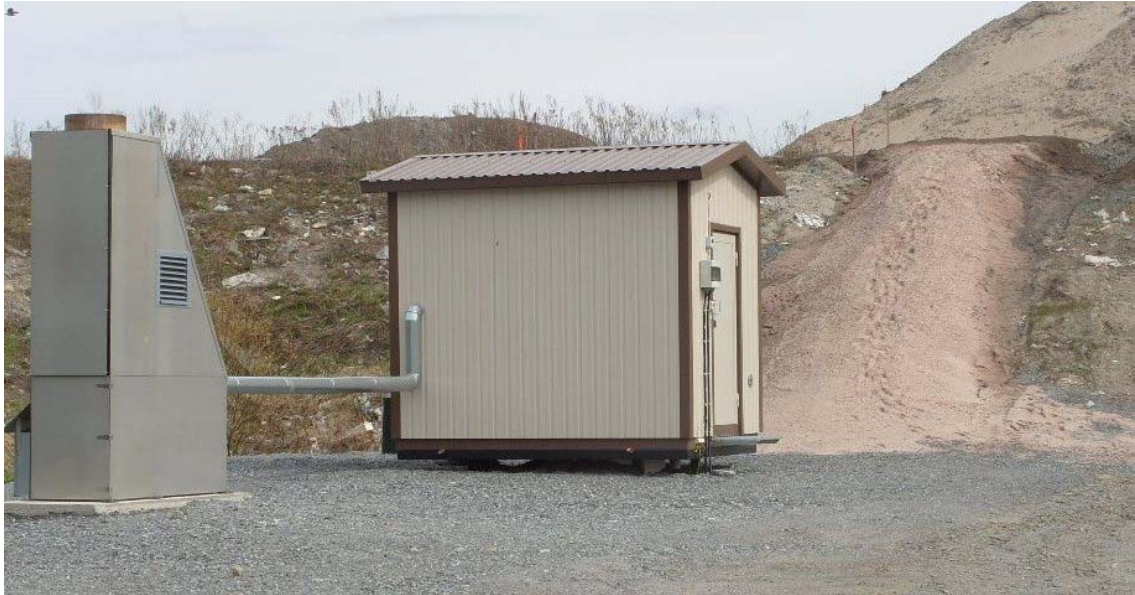
KUVA 7. Kaasun vedenerotus- ja venttiiliyksikkö sekä imu ja polttoyksikkö
