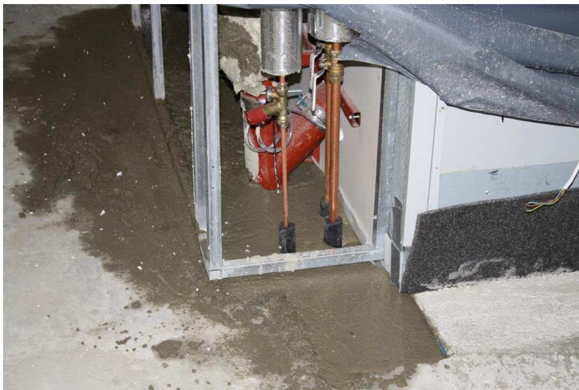
Kuva 7. Kylpyhuoneen reunavalut ja hormitilan palokatko (Parmarine 2018)
