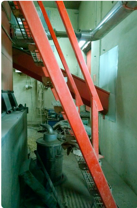
Bild 36. Utrymme att gå mellan panna och vägg. (Foto: Engelbert Engblom)
