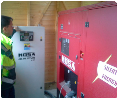
Kuva 42. Mikael Jern ja koulutilan varavoimalaitos sähkökatkosten varalta. Aggregaatti pystyy tuottamaan käyttösähköä useamman tunnin katkoksia varten muun muassa navetan ruokintalaitteille ja lypsyroboiteille. (Kuva: Juha Tiainen)
