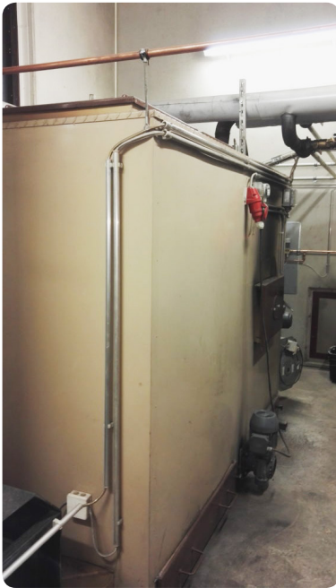
Kuva 65. Tilan lämmityslaitteisto. (Kuva: Riina Lahtomäki)
