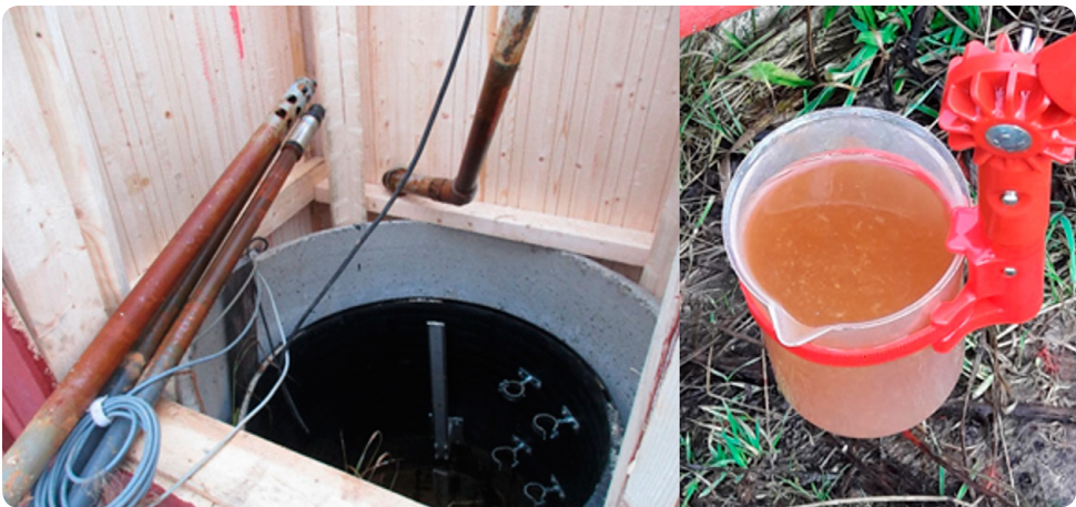
Kuva 94. Vasen kuva: Raudan värjäämät pohjoisen kaivon mittausanturit marraskuussa 2017. Oikea kuva: Eteläisen kaivon vesinäyte lokakuussa 2017. (Kuva: Kaija Karhunen)
