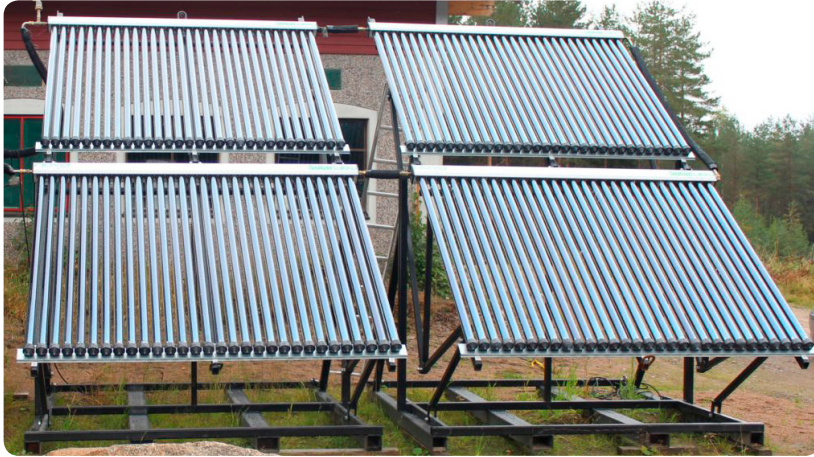
Kuva 55. Tyhjiöputkikeräimillä tuotetaan kesäajan lämpöenergia. Lämpölaitokseen asennetaan 4 kpl 30-58/1800 Nova-tyhjiöputkikeräintä, joiden aktiivinen keräinpinta-ala yhteensä 17,6 m 2 ja maksimiteho 12 kW per keräin. Järjestelmään kuuluu myös SR982 automaatiikka- ja pumppuryhmä energianmittauksella. Järjestelmän varaaja on Akva Solar 2000. (Kuva: Hannu Vilkkilä)
