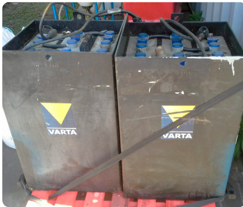
Kuva 56. Aurinkokennojärjestelmään tulevia akkuja. Jännite 12 V ja kapasiteetti 720 Ah per akku. (Kuva: Juha Tiainen)
