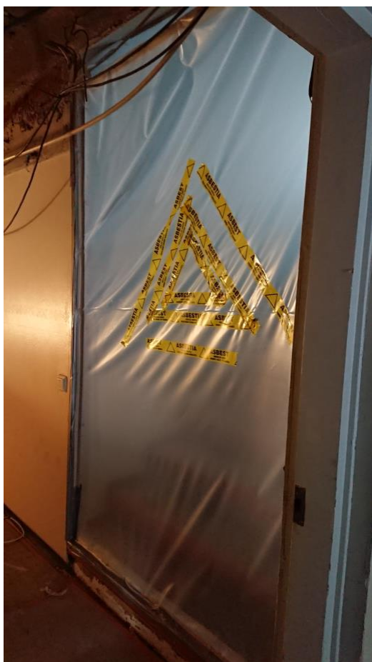
Kuva 8, rappukäytävässä suoritettujen pintojen asbestipurun takia rappukäytävä on eristetty ja kulku tapahtuu käyttäen muita kulkuteitä.
