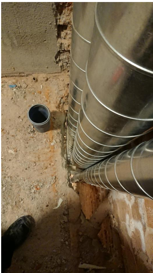
Kuva 6, iv-kanavia asentaessa jouduttiin yllätykseksi kaventamaan holvia joistakin kerroksista niin, että iv-kanavat mahtuivat hormiin
