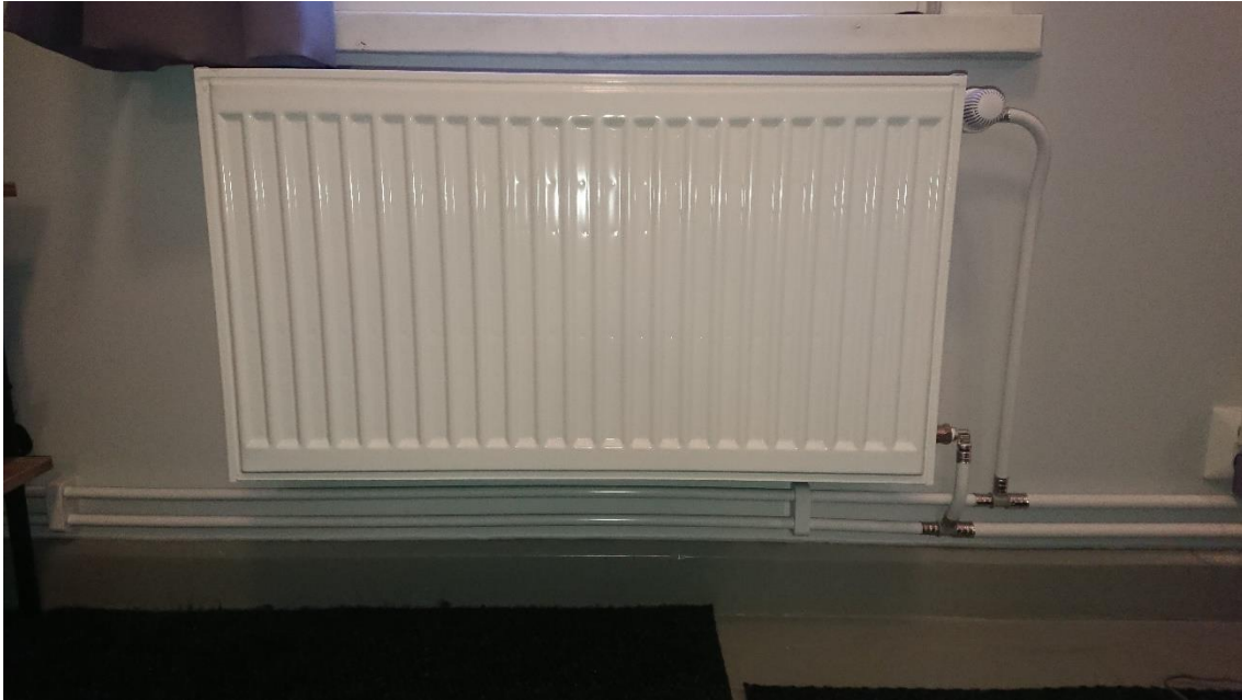
KUVA 11. Paneeliradiaattori, jossa putkikytkennät ja venttiilit
