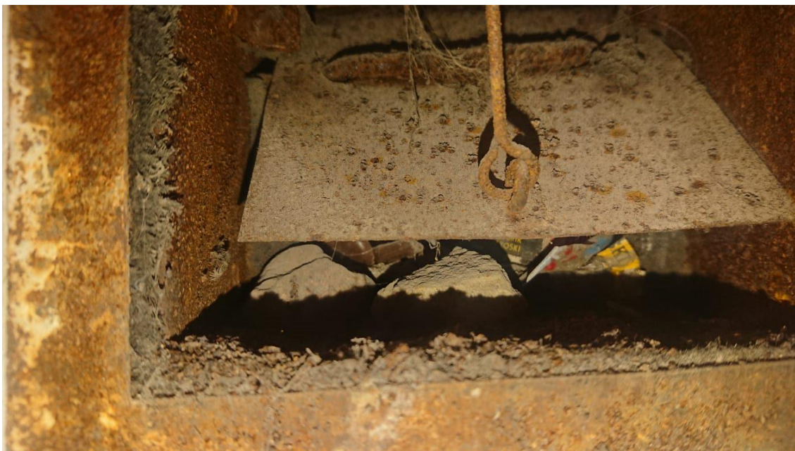
KUVA 4. Vanha ilmanvaihtohormi, joka on osittain romahtanut
