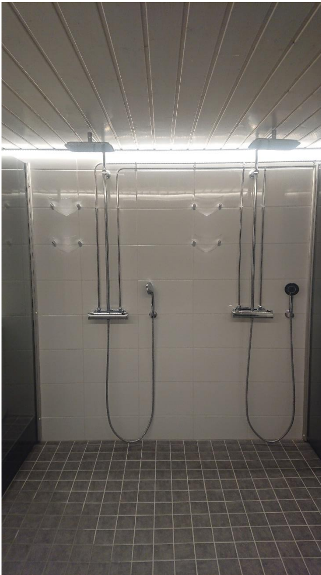
KUVA 13. Kellarin kylpyhuoneen putkikytkennät
