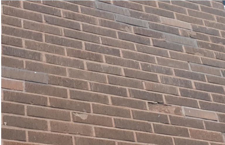
Kuva 10. Etelän puoleinen paikoin rapautunut tiiliseinä.
