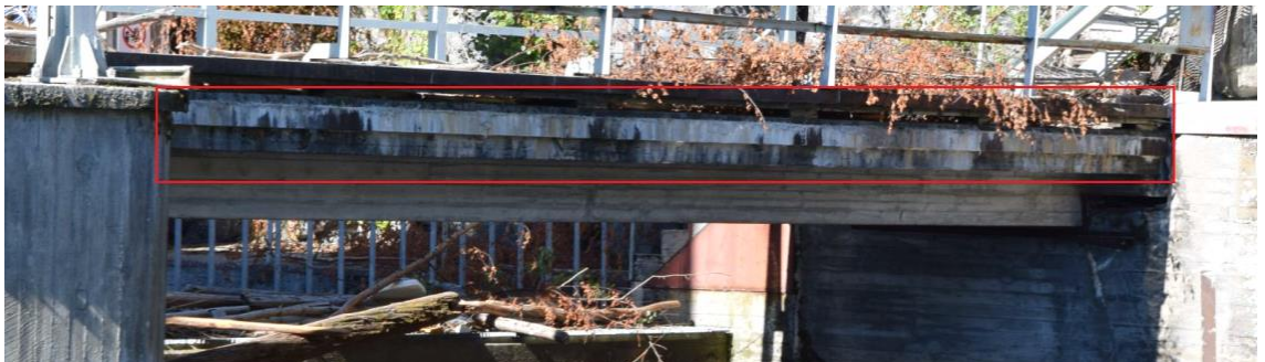
Kuvio 7. Betonin lievää/merkittävää rapautumista sekä vesivuotoa (VRT Oy 2018b, 9)
