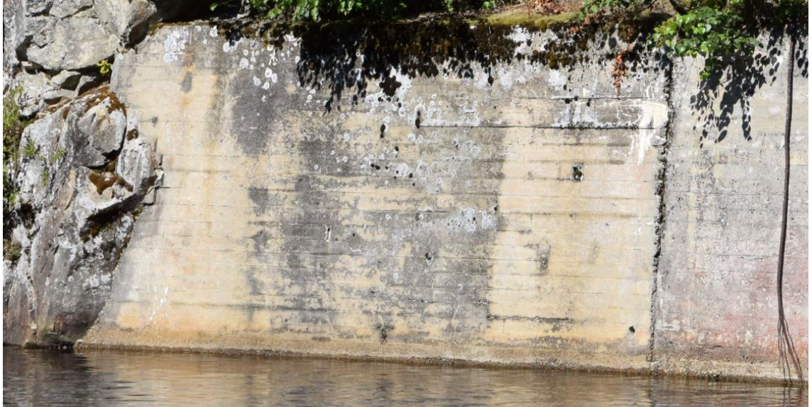
Kuvio 16. Betonin lievää/merkittävää rapautumista yleisesti havaittavissa (VRT Oy 2018b, 18)
