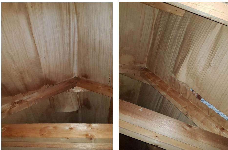
KUVAT 12 ja 13. Aluskatteen vaurioista (Pulkinen 2018-09-22)
