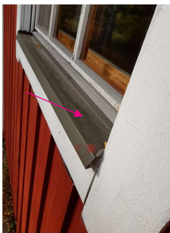
KUVA 17. Vesipellin väärä kallistussuunta (Pulkinen 2018-09-22)
