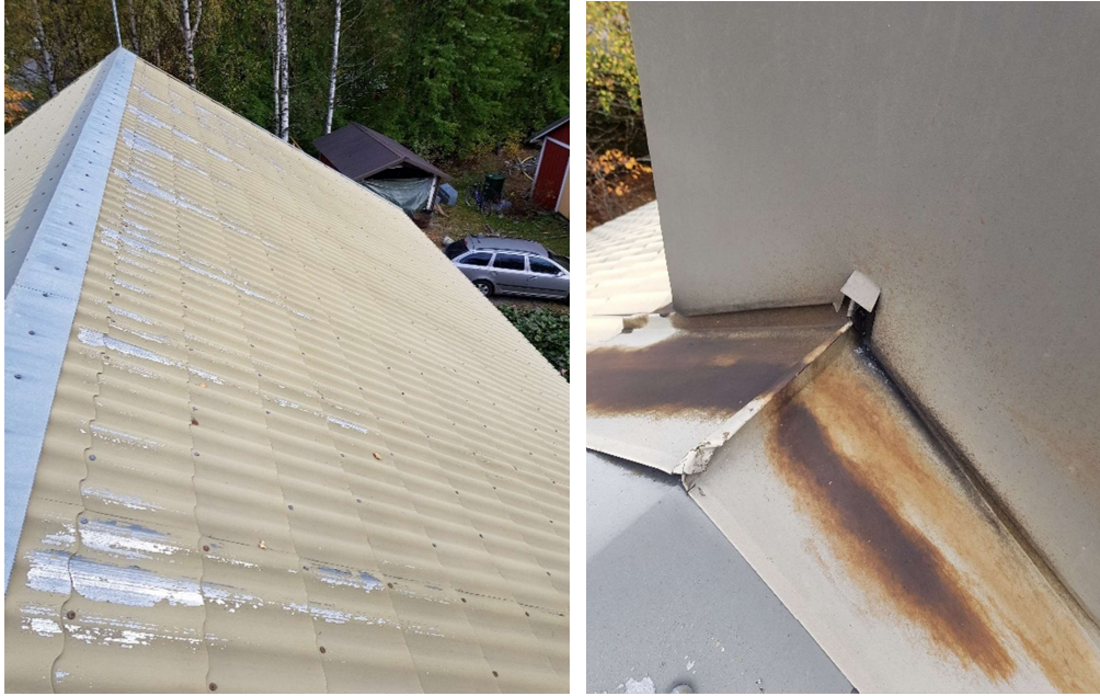
KUVAT 14 ja 15. Vesikatteen vaurioista (Pulkinen 2018-09-22)
