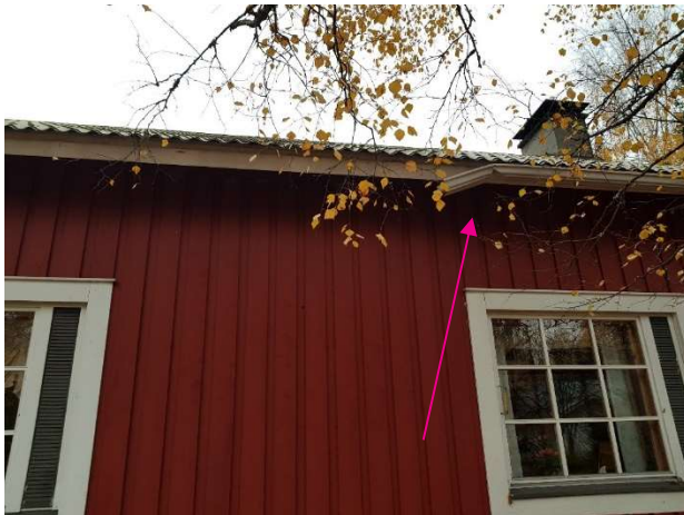
KUVA 16. Puutteellinen räystäskouru (Pulkinen 2018-09-22)
