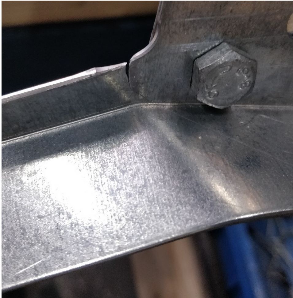
Kuva 22. TKL3 osan 1 repeämäkohta
