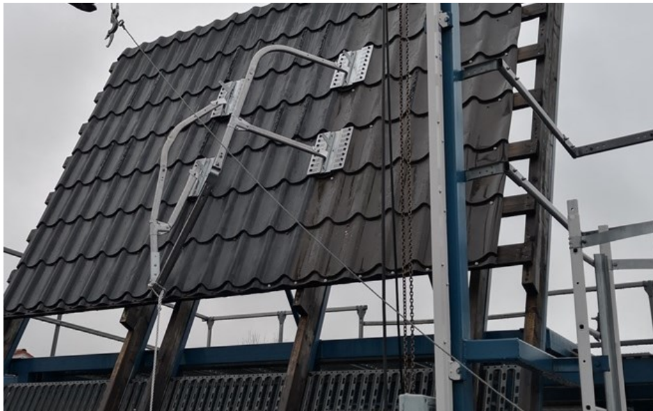
Kuva 66. Muotokaton kattoluukunkaiteet tiputuskokeen jälkeen
