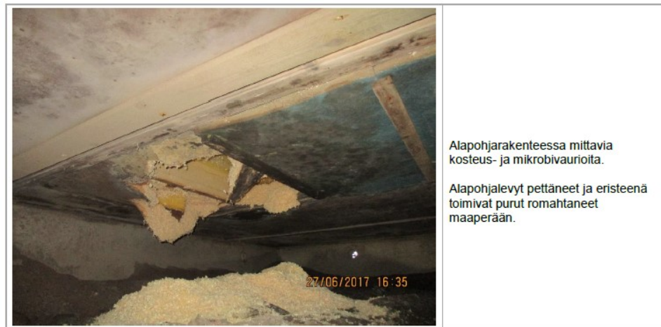
Kuva 15. Alapohjan vauriot, romahtanut rakenne (Materiaaliarkisto, Pulkkinen).
