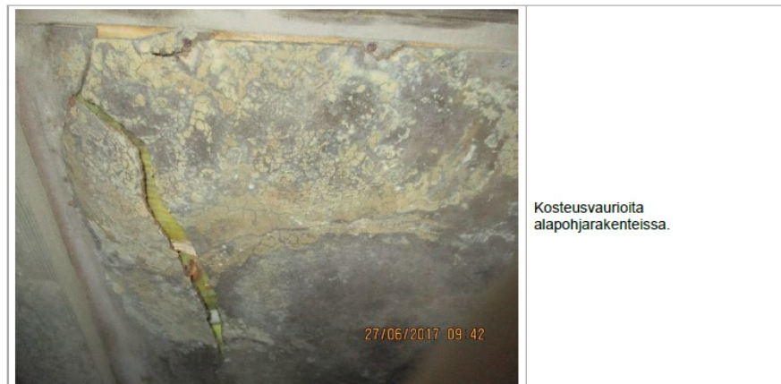
Kuva 16. Kosteusvaurio (Materiaaliarkisto, Pulkkinen).
