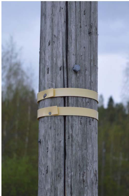
Kuva 6. Varoitusnauhoin merkattu sähköpylväs. Kuvan pylvääseen ei saa kiivetä edes sen ollessa tuettuna. (Työturvallisuuskeskus, Pylvästyö osa 2)
