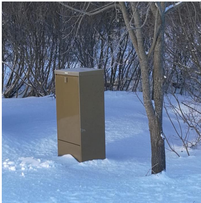
Kuva 2. Maakaapelointihankkeen yhteydessä asennettu jakokaappi. Jakokaapin koko vaihtelee siihen liitettävien kaapelien määrän mukaisesti. (Mika Rekola, 2019)
