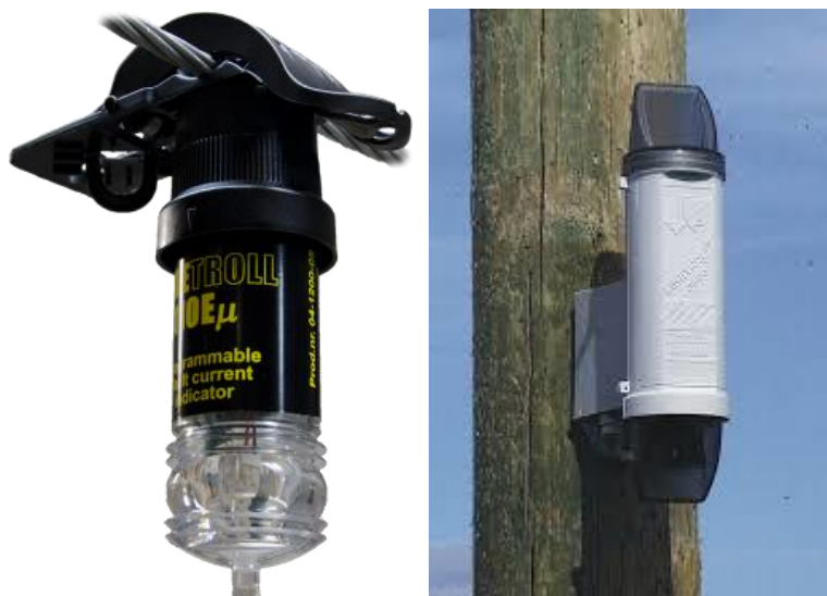
Figur 5.2 Linjemonterad FPI LineTroll 110E \mu r (t.v.) samt stolpmonterad FPI LineTroll R400D (t.h.).
