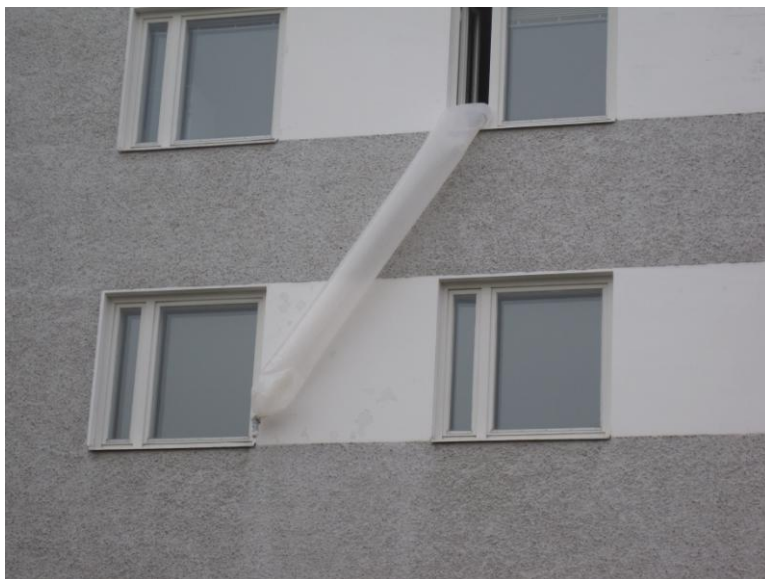
Kuva 5. Muovisukka on johdettu ulkoilmaan.
