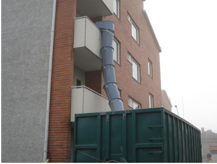
Kuva 11. Roskakuilu on johdettu palavien jätteiden lavalle.
