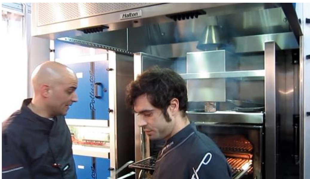
Kuva 24. Puuhiiliuuni, jonka päällä on CMW-FMOD-huuva [10].
