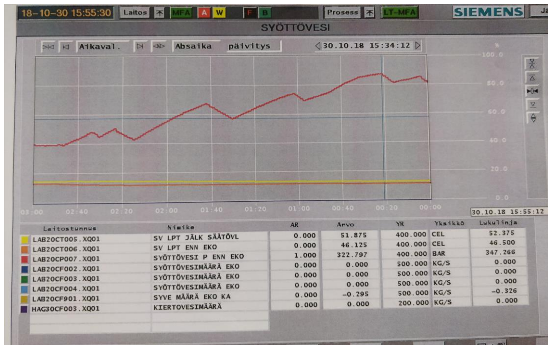
Kuva 9. Kattilan painekäyrä painekokeessa
