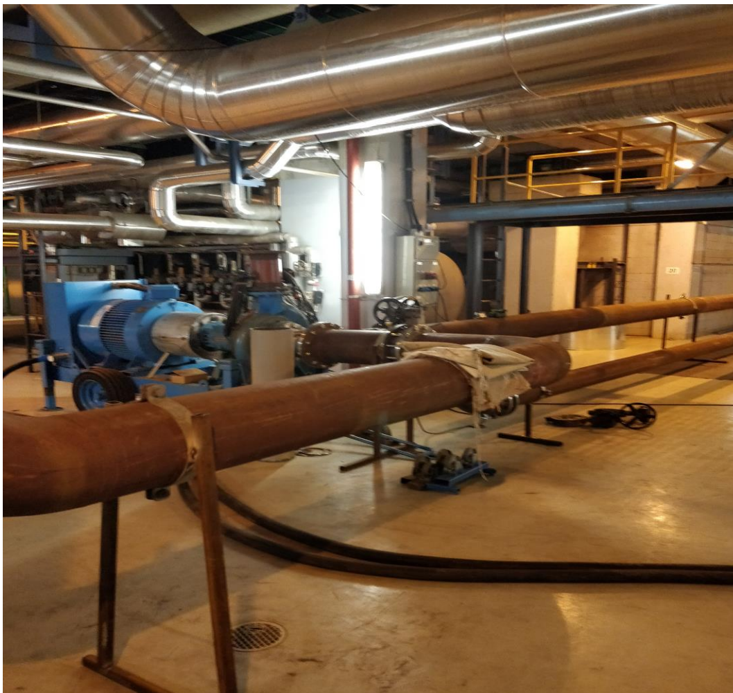
Kuva 8. Peittauspumput sekä putkistoa
