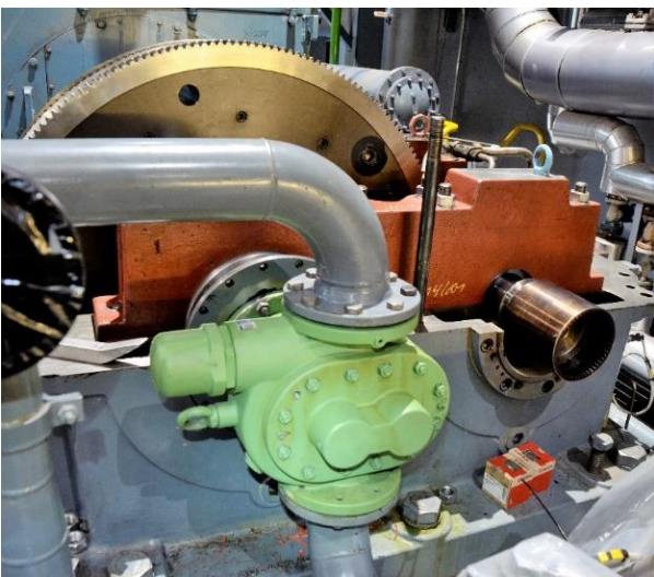
KUVA 12. Kuvan keskellä oleva komponentti on pääöljypumppu
