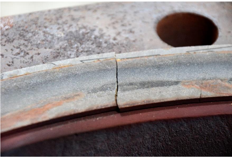
KUVA 23. Katkeama poistohöyryputken tiivisteessä
