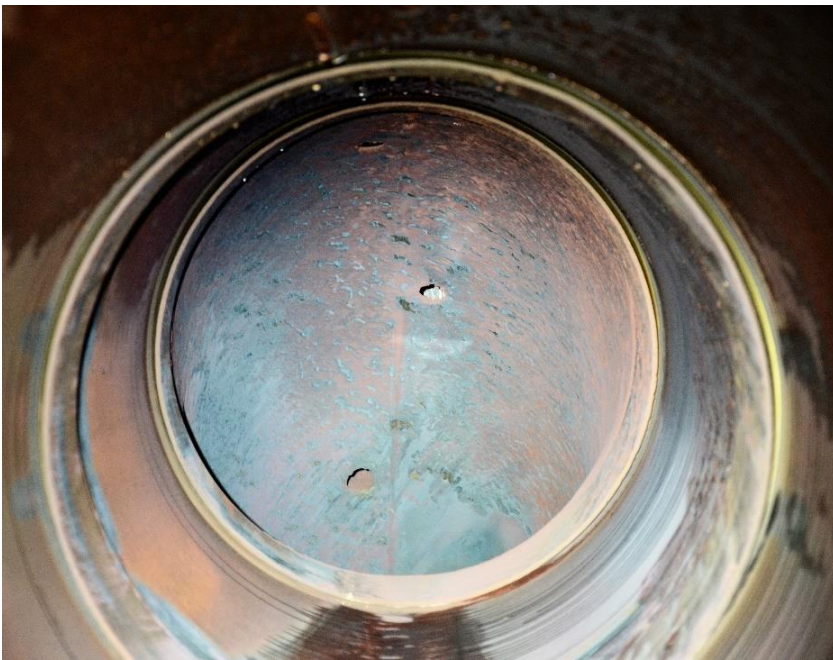
KUVA 76. Poistohöyryputken mutkassa korroosiota
