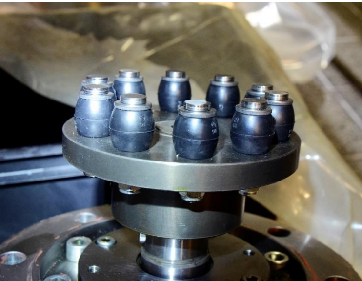
KUVA 79. Pääöljypumpun uudet kytkintapit
