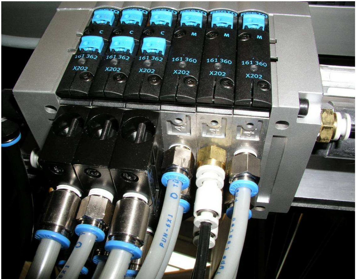
Kuva 27. Käytössä olevat paineilmalähdöt
