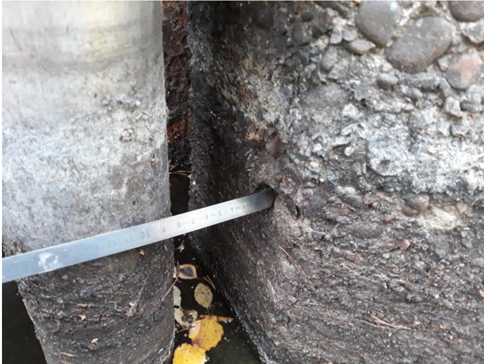
Kuva 16. Esimerkki betonin rapautumissyvyyksien mittauksesta
