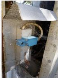
Luukun raja-anturin vaurio.
