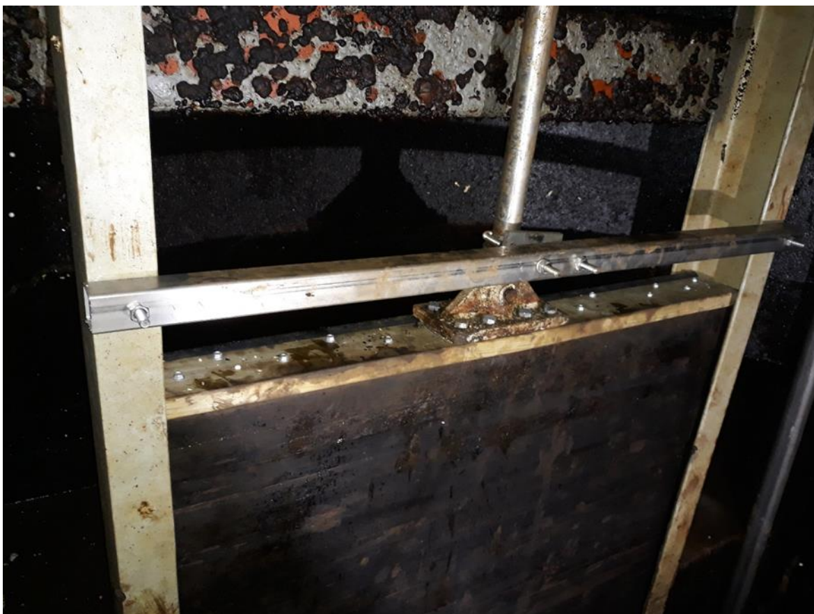
Kuva 14. Puurakenteinen luukku 70-luvulta. (Tarkastuksen yhteydessä tiiviste ja ohjaintuki asennettu)
