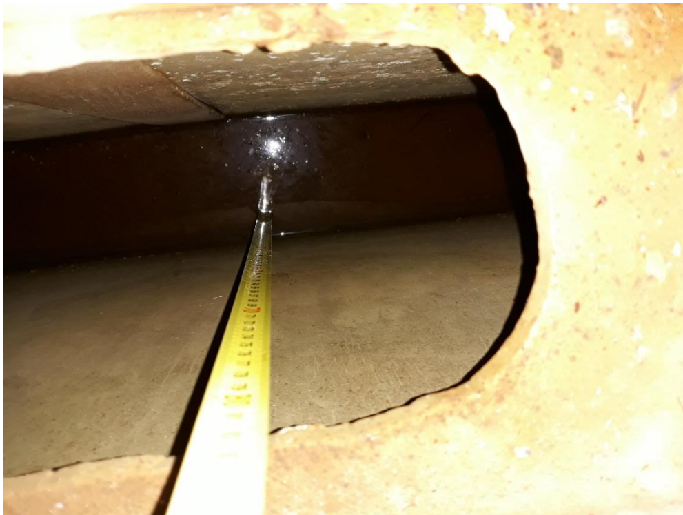
Kuva 15. Puhki ruostunut luukkurakenne mittauksien alla
