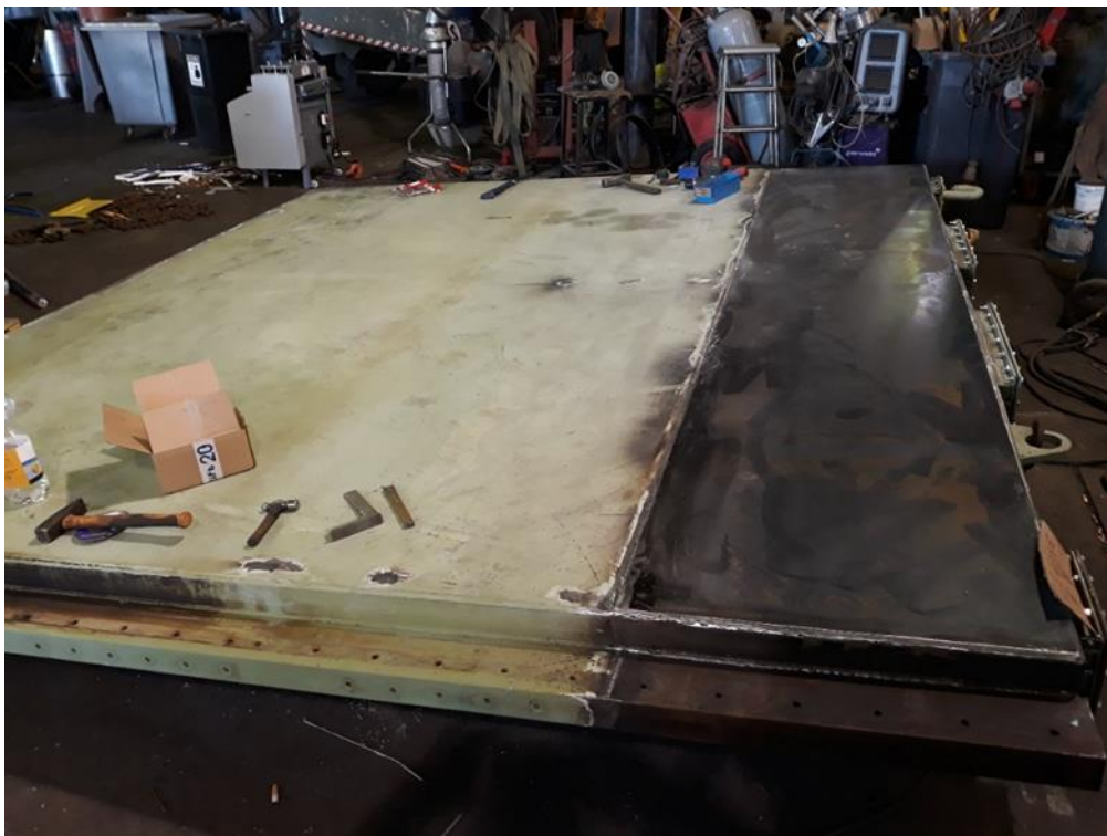
Kuva 13. Saneerauksen kohteena oleva luukku
