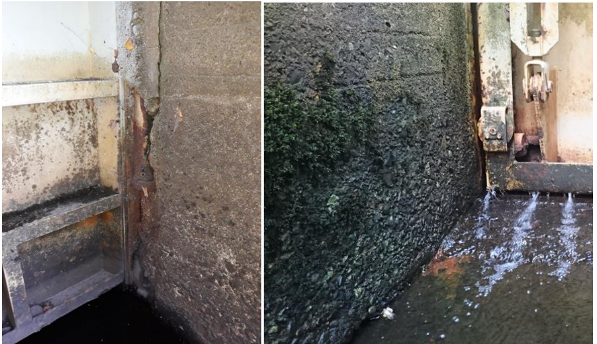
Kuva 9. Lämmityselementti näkyvissä (vas.), Laatan ja seinän välinen liitos rapautunut (oik.)
