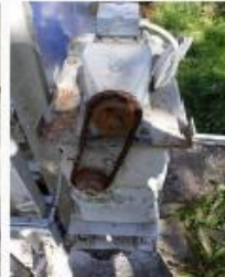
Rasvaus puutteellinen ja käsikäytön mahdollisuus puuttuu.
