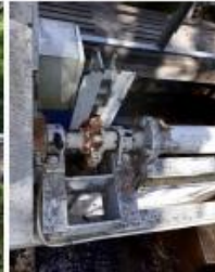
Kuluneisuutta ja puutteellinen voitelu.
