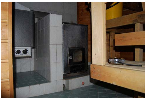
Kuva 13: Kiukaat, koroke ja putket.
