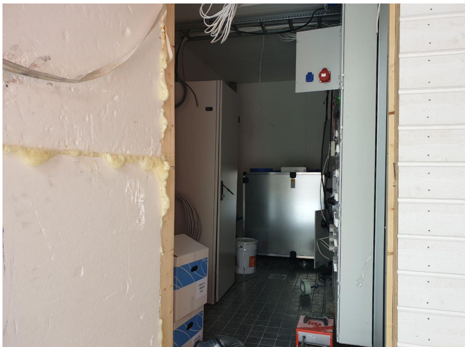
Kuva 22. Ilmanvaihtokoneen sijainti teknisessä tilassa Mikkelin KEVA yksikkö.
