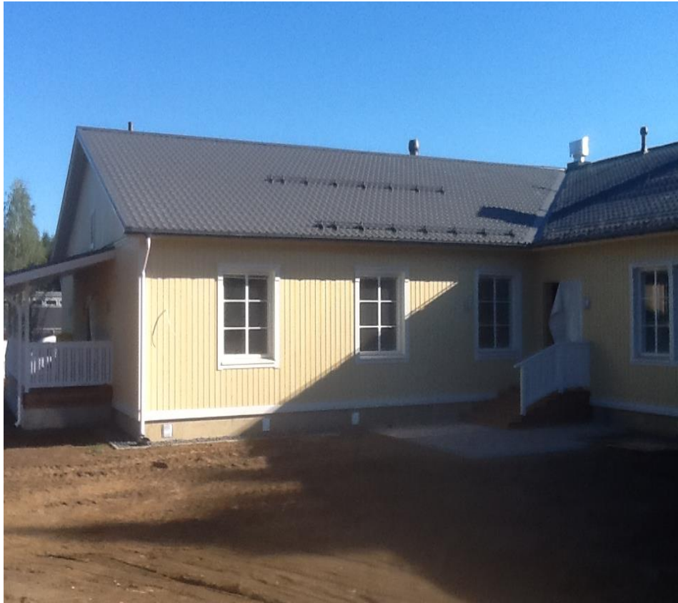
Kuva 3. Hammaslahden palvelukodin toteutettu ryömintätilan tuuletus.
