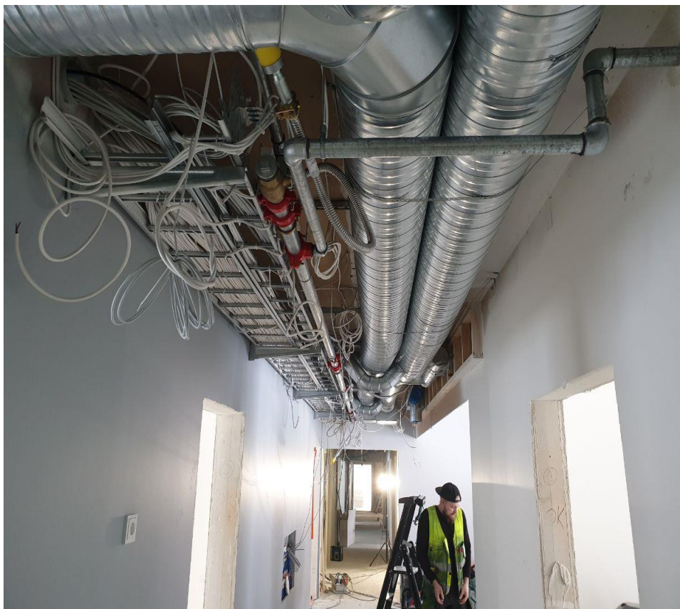
Kuva 21. Talotekniikka sijoitettuna käytävien kattoon. Mikkelin KEVA- yksikkö.
