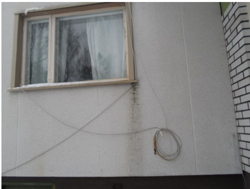
Kuva 15. Valumajäljet ulkoverhouksessa (Matilainen 2019)
