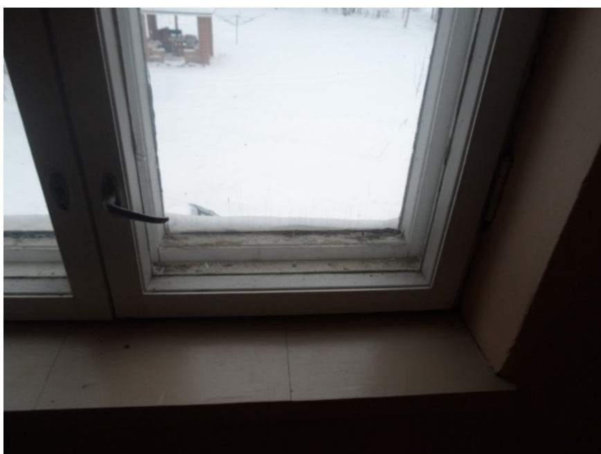
Kuva 16. Kosteusvaurioita ikkunassa (Matilainen 2019)
