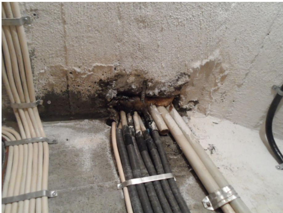
Kuva 17. Sähköpääkeskuksen kosteusvaurio (Matilainen 2019)
