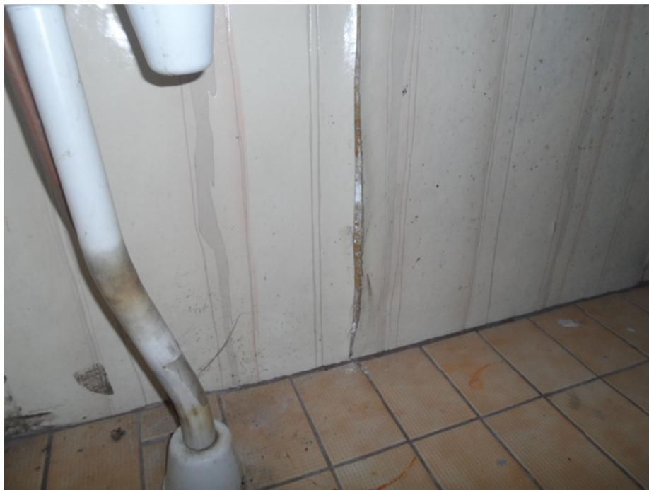
Kuva 18. Kellarin WC:n muovimaton sauma (Matilainen 2019)
