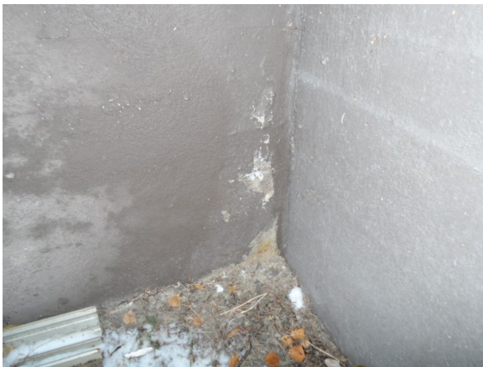
Kuva 9. Perustuksen vaurioitunut pinta (Matilainen 2019)
