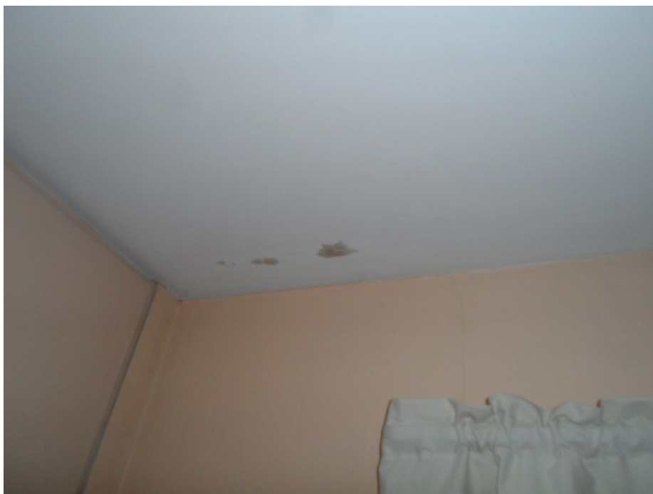
Kuva 11. Vuotojäljet laipiossa (Matilainen 2019)
