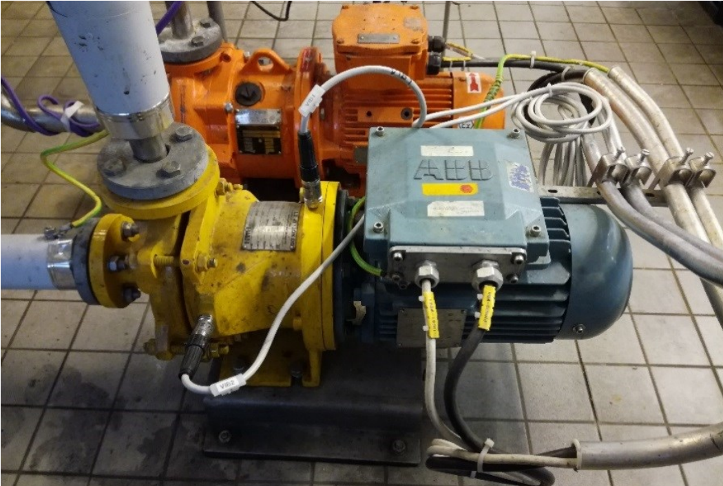
KUVA 22. PM505-pumppu antureineen, Ch1-laakerimittaus päällä, Ch2-siipipyörämittaus sivulla
