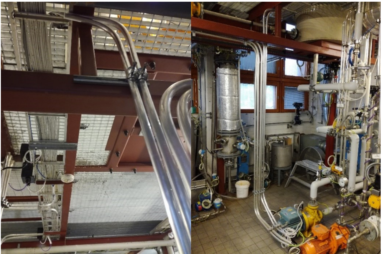
KUVA 19. JAMAK-kaapelointia kaapelisuojausputkien kautta PM505-pumpulle (turkoosi/keltainen)
