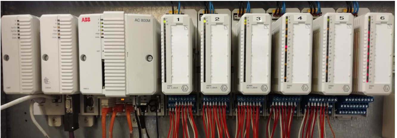
KUVA 1. ABB 800xA -automaatiojärjestelmän laitteisto (isoin PM861A/TP830, 5-moduuli DI890)
