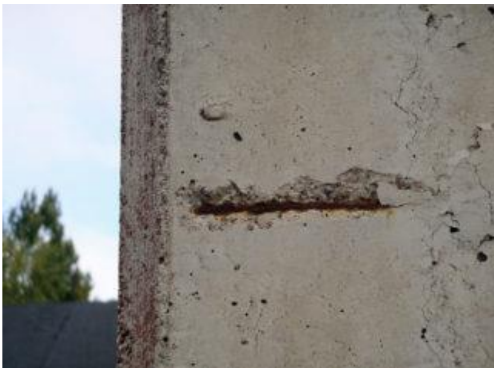
KUVA 1. Teräskorroosion vaurioittamaa betonia. (1.)
