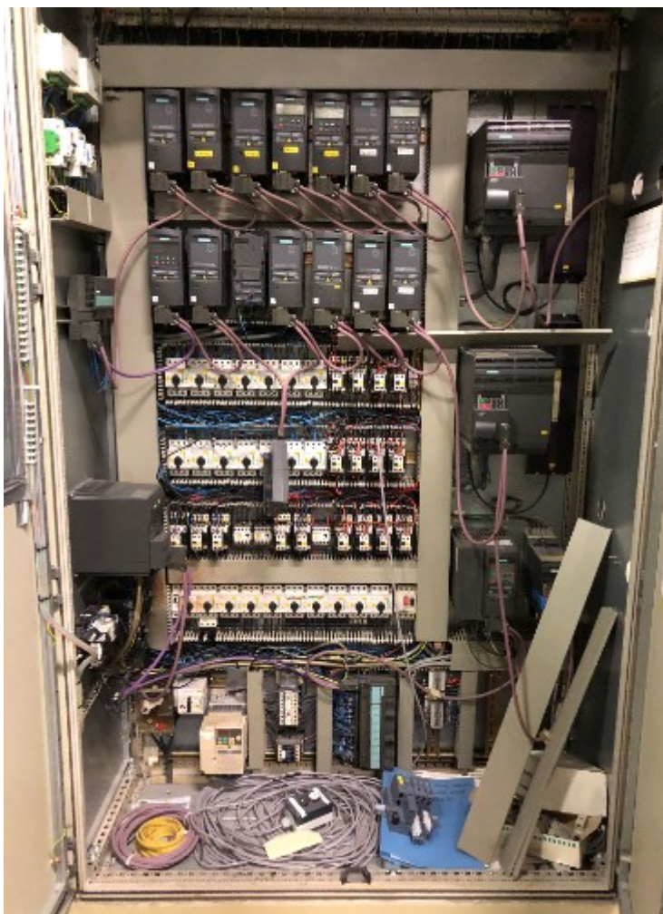
Kuva 32. CP4 sähkökaapissa sijaitsevat vaihdettavat taajuusmuuttajat.
