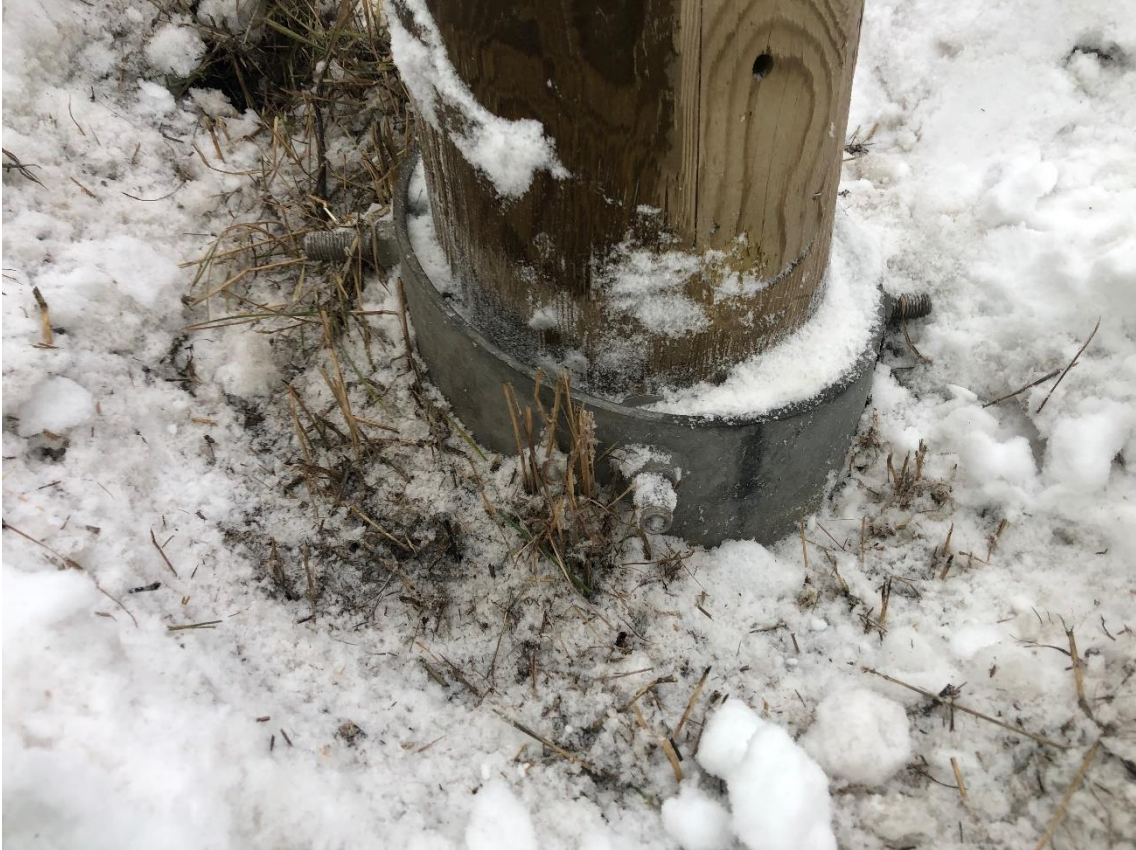
KUVA 12. Pylväs metallijalustalla. Ei suoraa maakosketusta.
