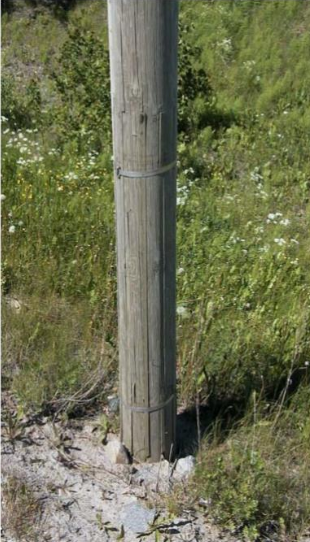
KUVA 6. Sektorisahattu pylväs (5, s. 6).
