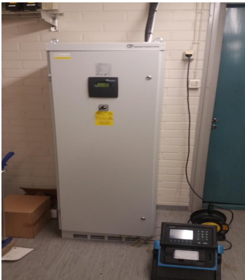
Figur 21. Statiska batteriet som installerades.
