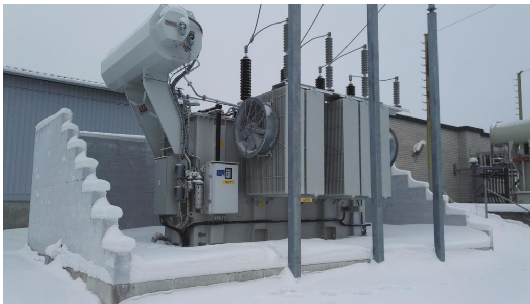
KUVA 5. ABB:n 40 MVA päämuuntaja Yara Siilinjärvi, kaivos (Strengell, 2019)
