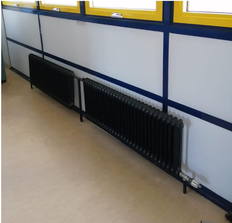
KUVA 13. Esimerkkikohteen lämmityspatteri (Petäys 2019)
