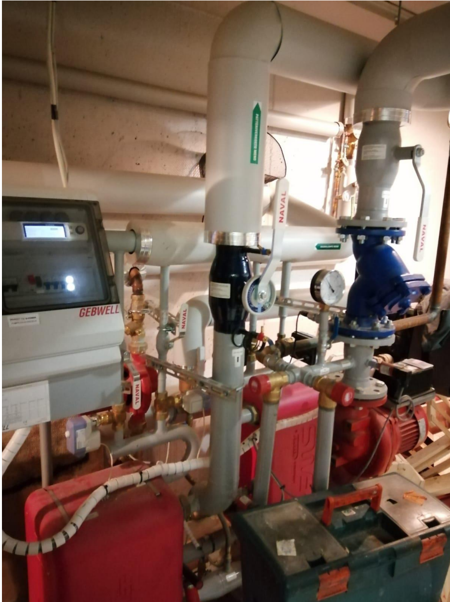
KUVA 12. Esimerkkikohteen kaukolämmön alajakokeskus (Petäys 2019)
