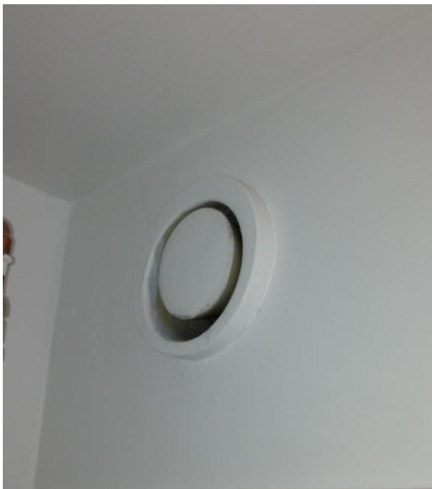
KUVA 17. Erään asunnon keittiön KGEB-poistoilmaventtiili (Petäys 2019)
