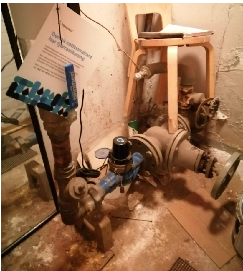
KUVA 18. Fiksuvesi -järjestelmän mittari pääsulun jälkeen (Petäys 2019)
