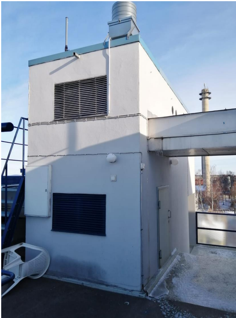
KUVA 19. Kammiopuhaltimien huoneet päällekkäin (Petäys 2019)
