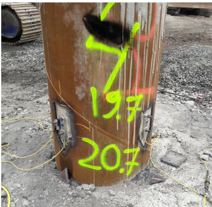
Kuva 15. Anturit kiinnitettynä PDA-mittausta varten. Paalun toisella puolella on samanlaiset anturit. [Santeri Mustonen 2018.]
