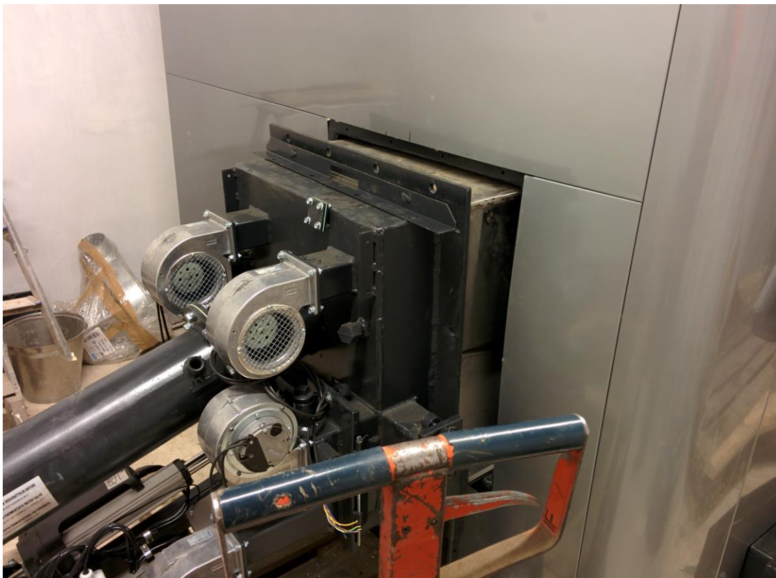
Kuva 11. Poltin ja ilmapuhaltimet.
