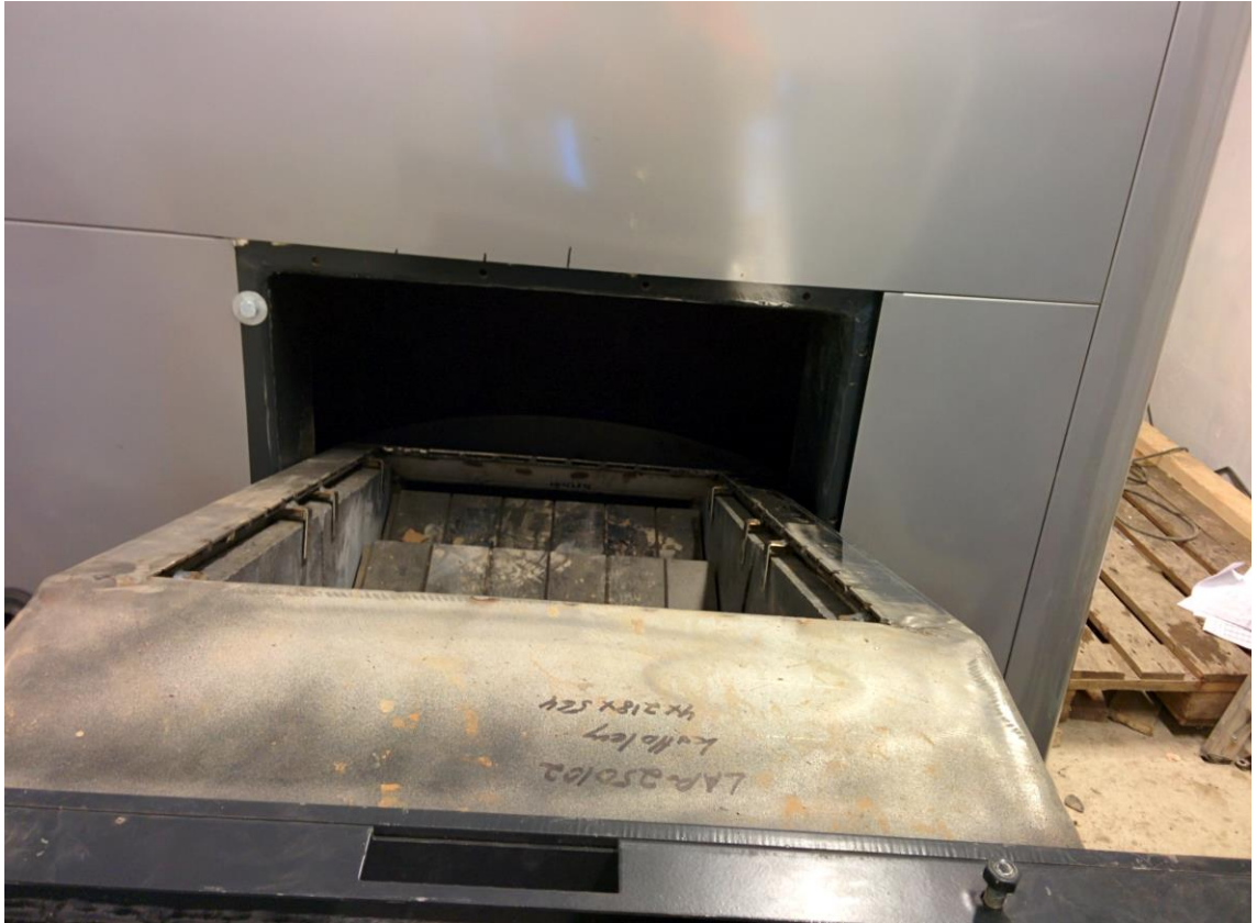
Kuva 10. Kattilan liikkuva arina, jonka päälle hake syötetään.
