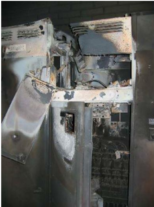
Kuva 10. Pienjännitekeskus, jossa on tapahtunut valokaarioikosulku. [4.]
