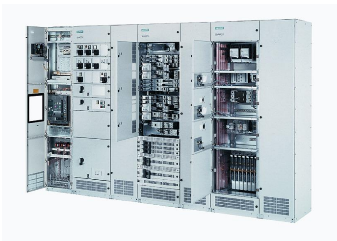
Kuva 7. Esimerkki sähkökeskuksesta. Siemens SIVACON S8- sarjan sähkökeskus. [16.]
