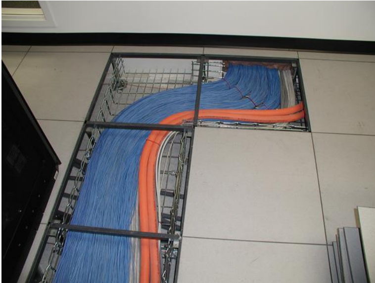
Kuva 4. Korotettu asennuslattia kojeistotilassa. [9.]
