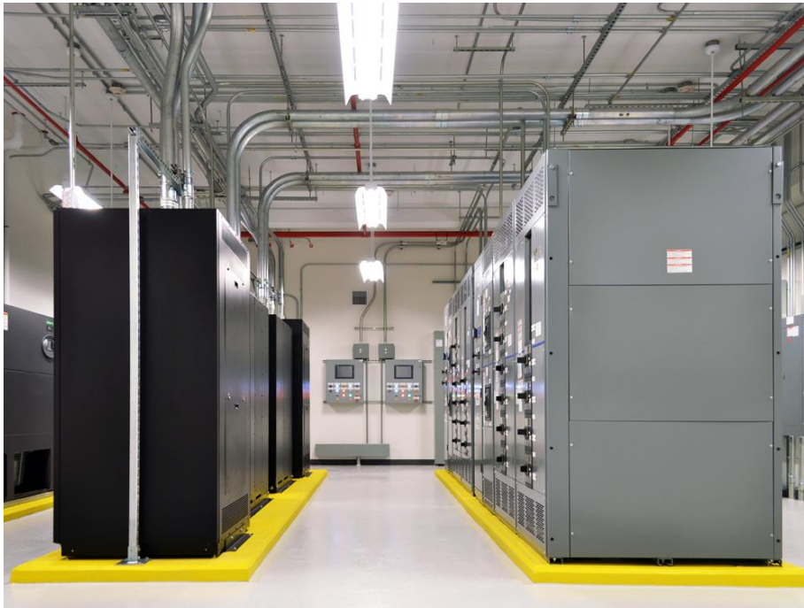
Kuva 9. Osa kojeistotilaa, jossa sähkökeskuksia. [19.]
