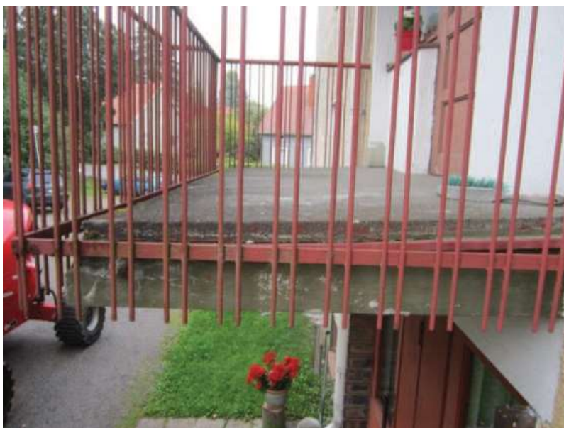
KUVA 2. Inspectan raportista otettu kuva tuuletusparvekkeesta, josta näkyy laattojen välissä kulkeva vedenohjauspelti sekä kaitteet.
