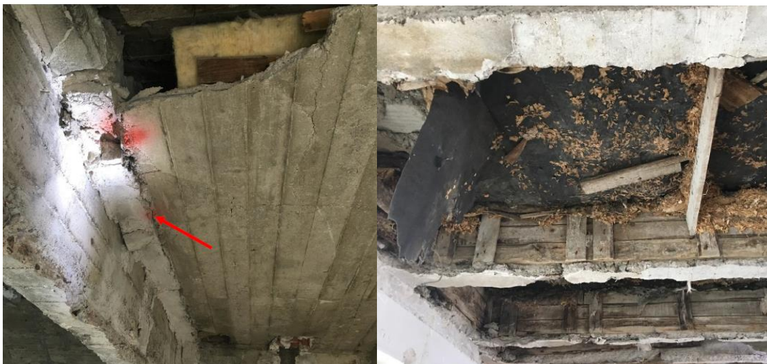
Kuva 21. Vasemmassa kuvassa näkyy, että laatta ei ole viety loppuun asti vaan välissä on siporex muuraus, joka katkaisee laatan. Oikeammassa kuvassa taas havaitaan sen, että osa ylälaatasta on ilmeisesti valettu alalaattapalkiston sisällä olevan kutterilastun varaan, joka on erotettu tervapaperilla. [21]
