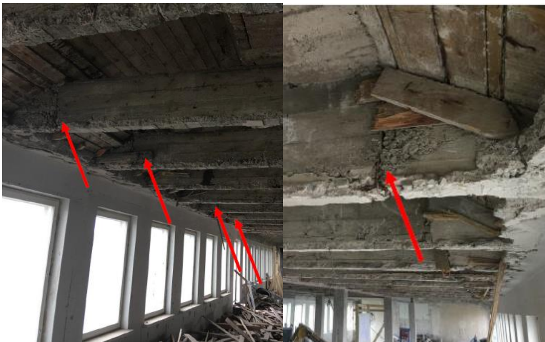
Kuva 20. Kuvassa nähdään, että palkisto on valettu kahdessa osassa erikseen, työsauma on havaittavissa [21].
