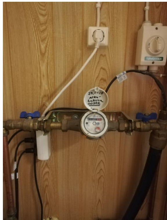
Kuva 26 Maastossa kulkevan 40mm vesijohdon liitos henkilöstötilojen vesiverkoston, ja vesimittari (Mikael Saja)
