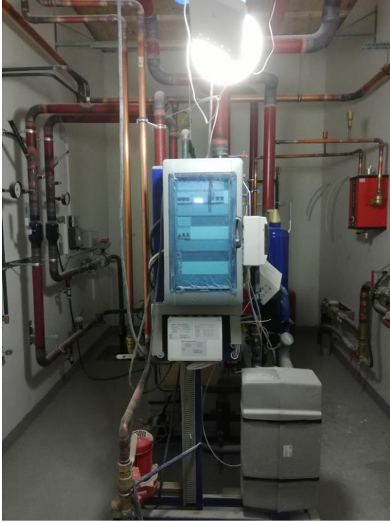
Kuva 34 Kaukolämmön lämmönvaihdin (Mikael Saja)
