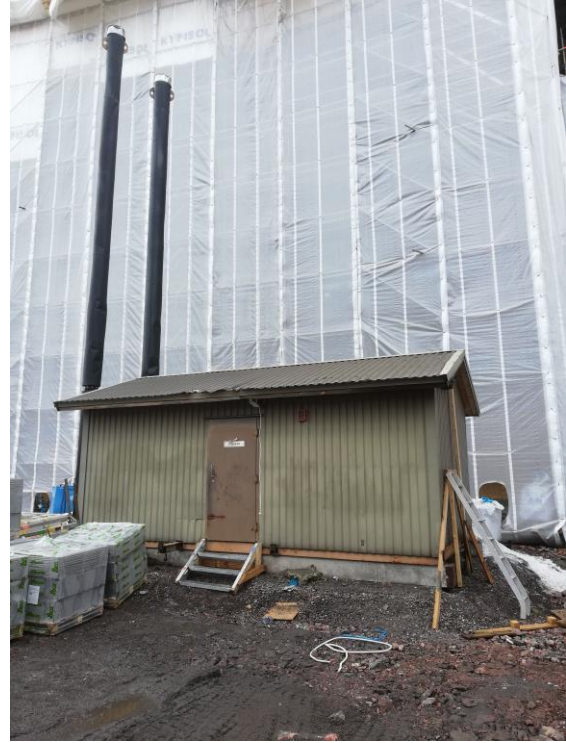
Kuva 35 Öljylämpökontti Keskuspuiston Ammattiopistolla (Mikael Saja)
