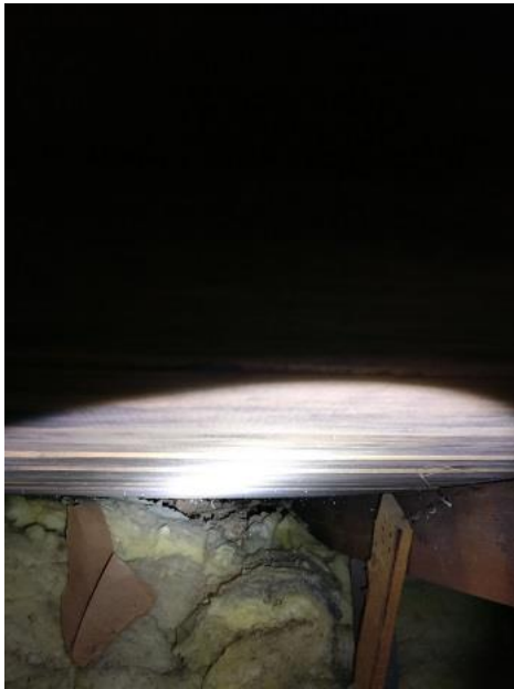
KUVA 29. Yläpohja, vinojen osuoksien tuuletusrako lähes tukossa
