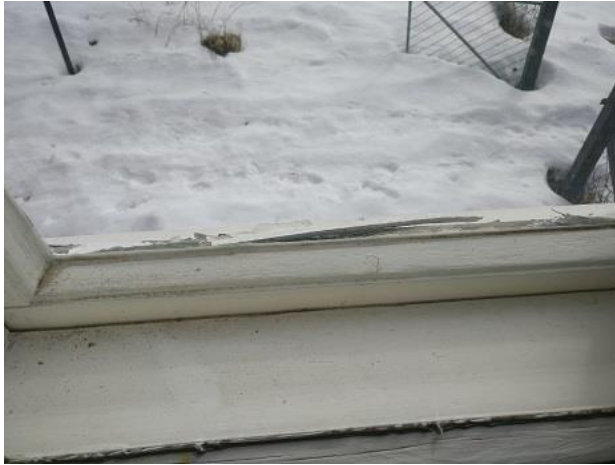
KUVA 30. Ikkunan karmin ja puitteen alaosa. Maalipinta on erittäin kärsinyt
