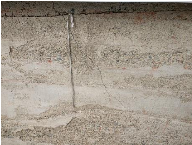
KUVA 27. Sokkelia ja siinä oleva halkeama
