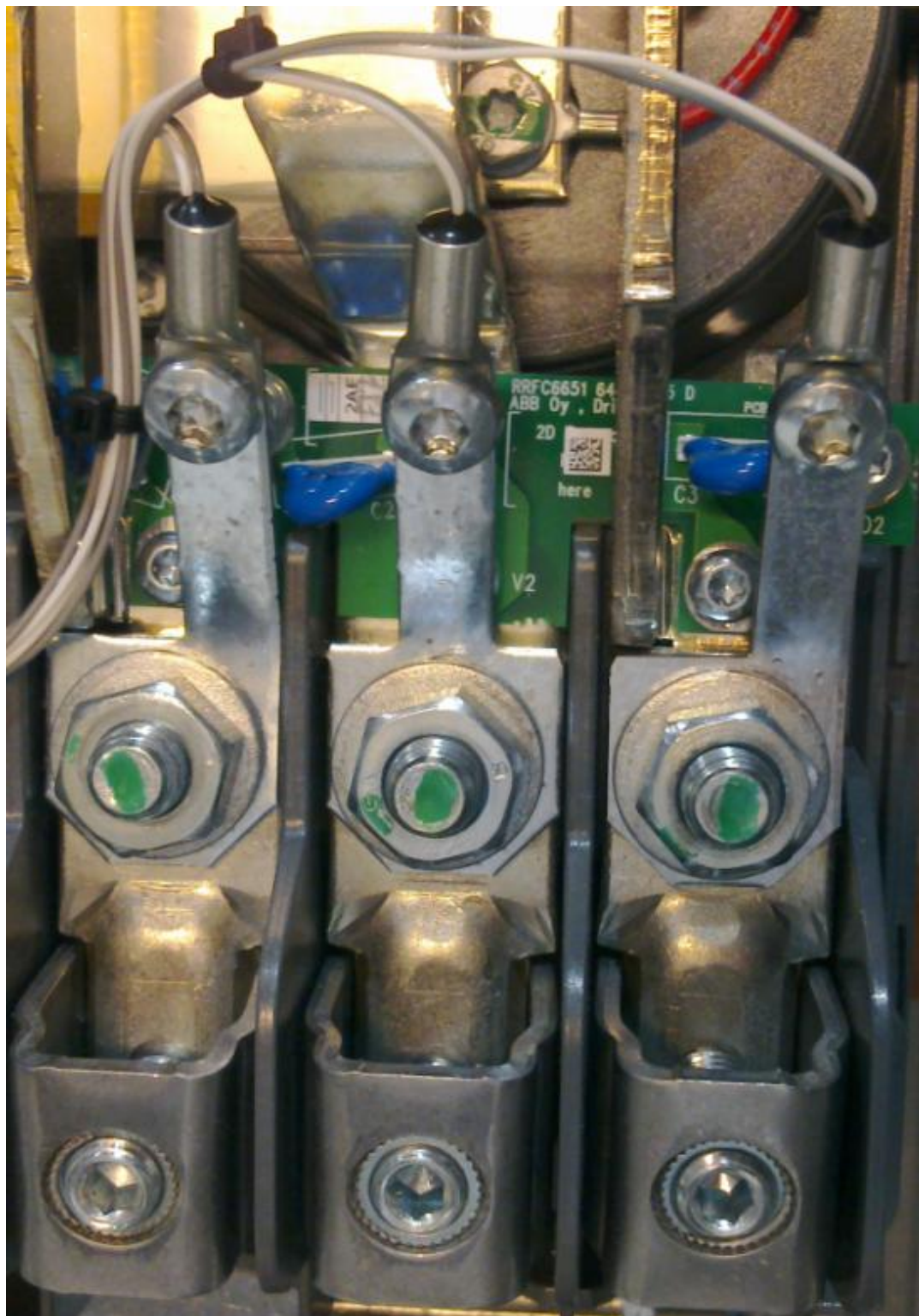
Kuva 18. Kenkämalliset anturit ovat kiinni teräksisessä lisäpalassa, joka on kiinnitetty taajuusmuuttajan liittimiin. Teräksinen lisäpala korvaa taajuusmuuttajan vakioliitoksessa olevan yhden aluslevyn (ilmaväljen takia), joten lisäpalan päälle tulee vain jousilaatta ja mutteri.
