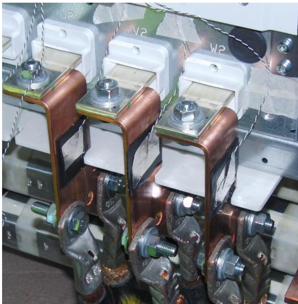
Kuva 19. G-runkoisen ACS850- taajuusmuuttajan lähtökiskot, joihin kenkämallinen PTC-anturi kiinnitetään.
