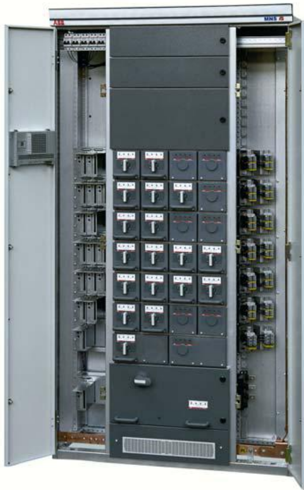
Kuva 4. MNS iS -keskuksessa on ohjauslaitetila vasemmalla ja moottorikaapeliteila oikealla puolella lähtöyksiköitä. /6/
