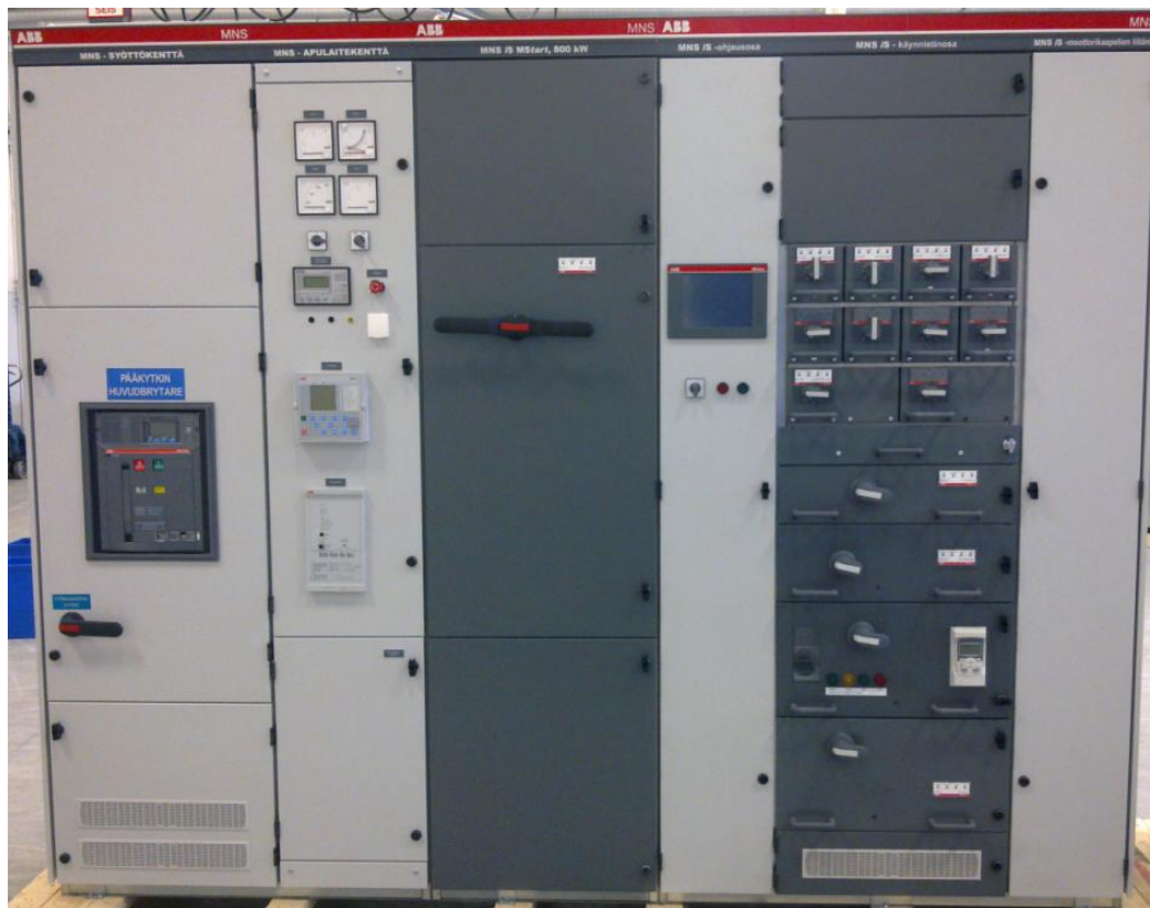
Kuva 5. MNS iS-keskuksen kokonaisuus, kuvassa vasemmalta oikealle: syöttökenttä, apulaitekenttä, kiinteä MStart, ohjausosa, käynnistinosa ja moottorikaapelien liitännäosa.
