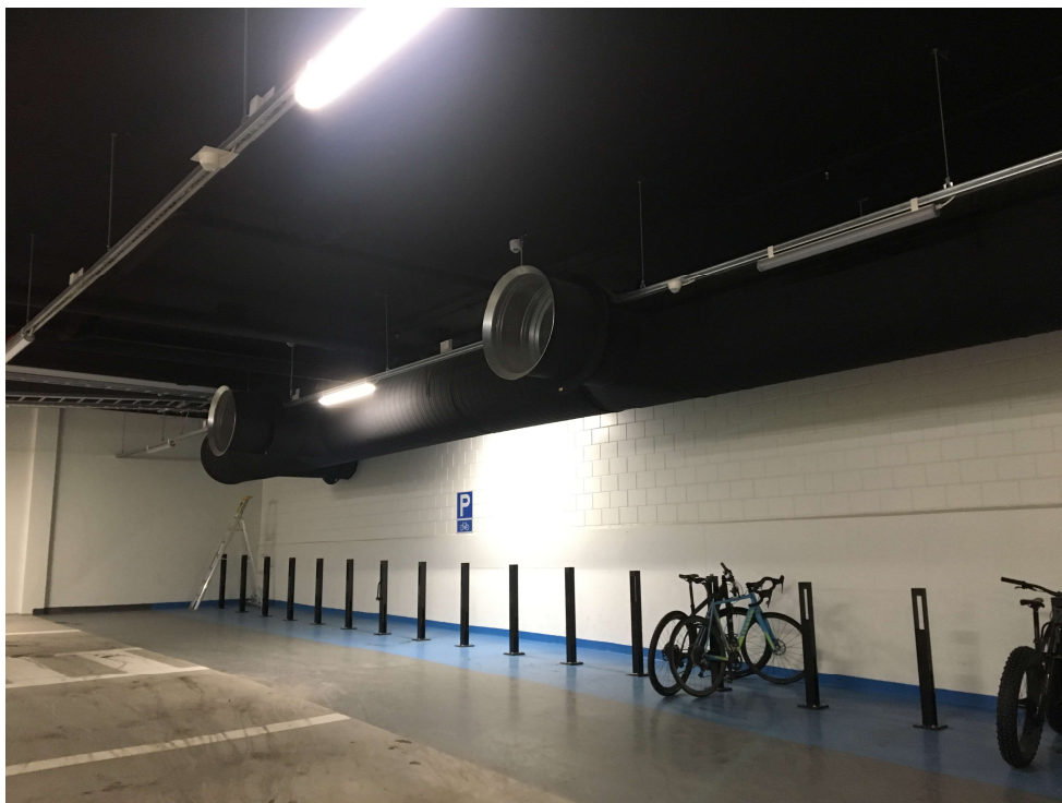
KUVA 2. Tuloilmakanava ja tuloilmahajottajat
