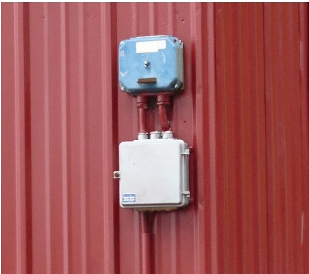
KUVA 10. Vaihtoliittimet sisältävä kotelo ja kuivaamon pääkytkin.
