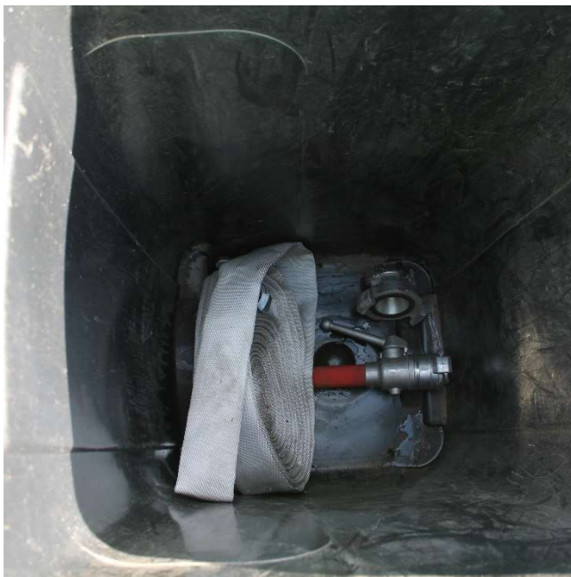
Kuva 14b. Esimerkki käytettävissä olevasta alkusammutuskalustosta Jätekkuko Oy:n jä- tekeskuksella
