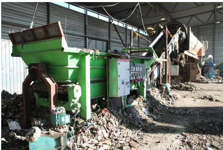
Kuva 12. Kuva havainnollistaa, kuinka helposti tulipalo pääsee leviämään, mikäli linjaston alkupäässä syttyy tulipalo.
