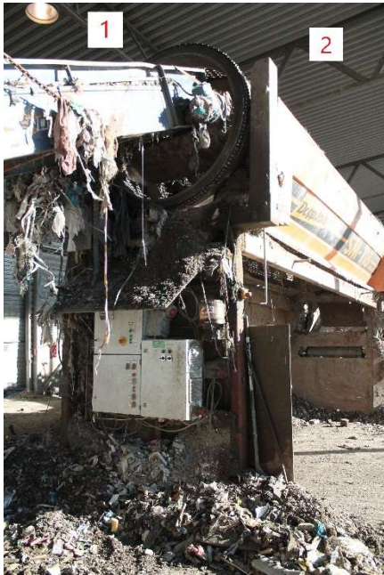
Kuva 8a. Rakennusjätejäämän kuljetinhihna (1) ja mekaanisen erottelijan (2) liitoskohta.
