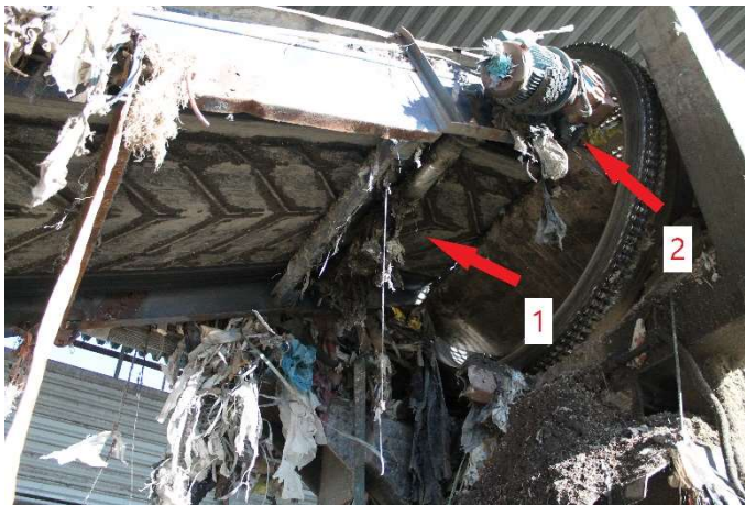
Kuva 8b. Jättemateriaalia, joka on jäänyt kiinni kuljetinhihnan ohjainrullan (1) ja hihnaa pyörittävän sähkömoottorin akselin väliin (2).
