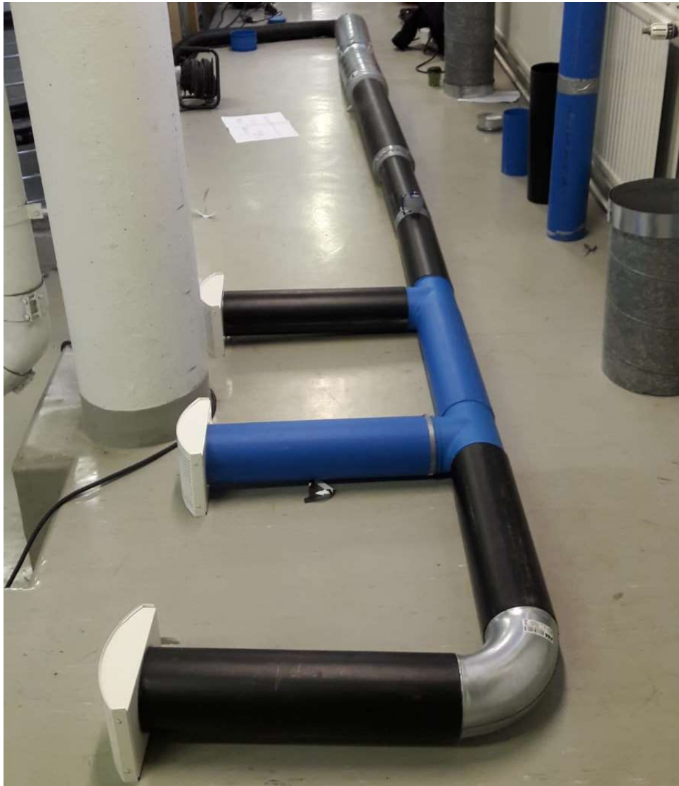
Kuva 9. Mittauksia varten rakennettu tuloilmakanavisto.
