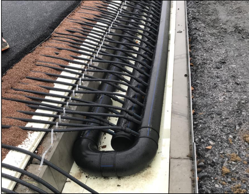
KUVA 11. Lämmönkeruuputkiston liittyminen jakotukkiin.
