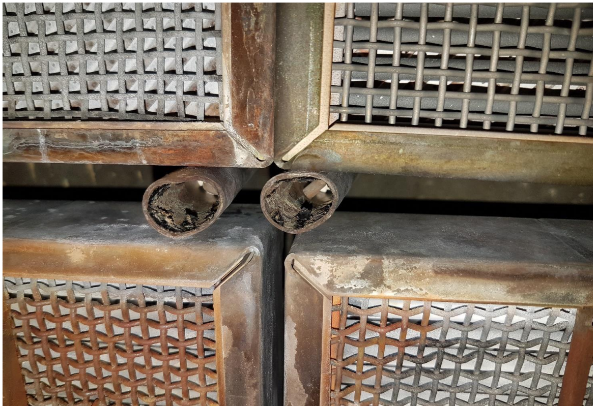
Sytytyspuolen impulssiputket, joissa öljyä
