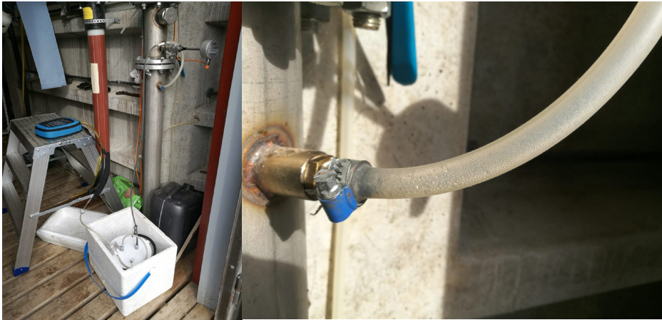
Kuva 3. Demonstraatiovaiheen kaasujen suodatusyksikkö toiminnassa märkämenetelmään perustuvalla biokaasulaitoksella (Kuvat: Tiina Saario)
