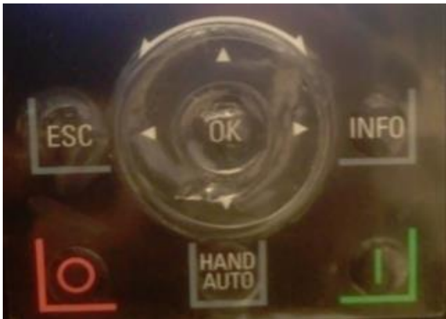
KUVA 5. Taajuusmuuttajan paneelin napit
