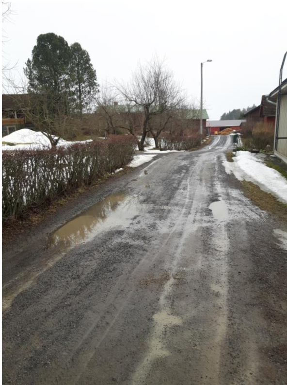
KUVA 3. Tie on painunut ja tierakenne kyllästynyt vedellä. Painanteet muodostavat lammikoita. sivuojat puuttuvat.
