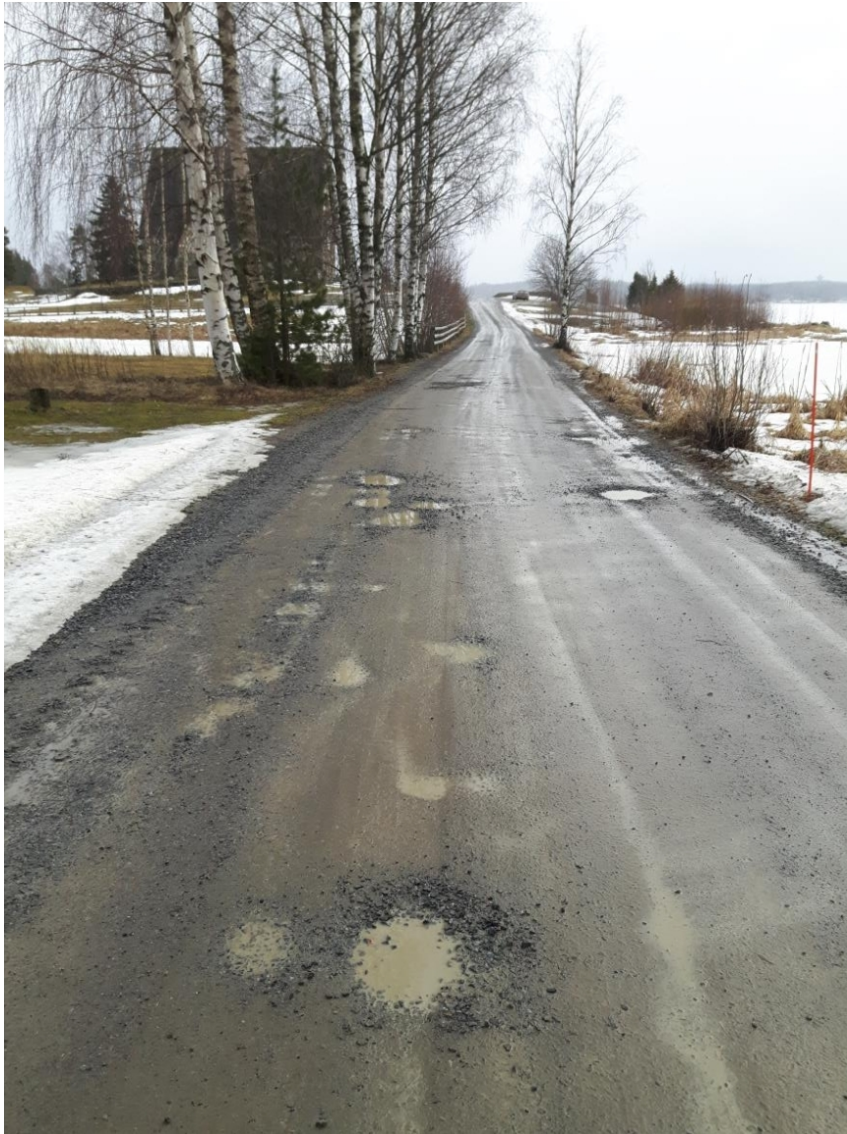
KUVA 5. Runkokelirikon aiheuttamia vaurioita.
