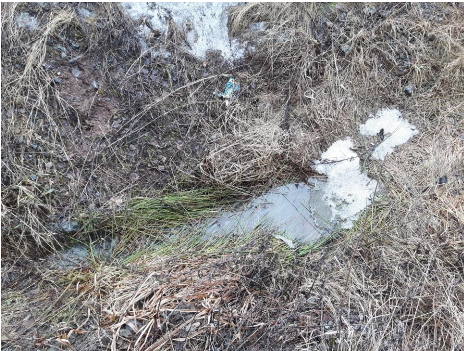
KUVA 7. Rumpu on tukossa. Rumpuja myös puuttuu useista tonttiliittymistä.
