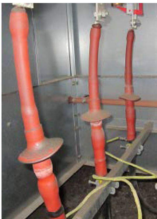
Kuva 25. Likaantuneet kaapelipäätteet puistomuuntamon kytkentäkennossa [33, s. 21].
